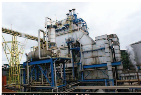
Usina de Co-geração, instalada no parque fabril de Vargem Bonita (SC)
