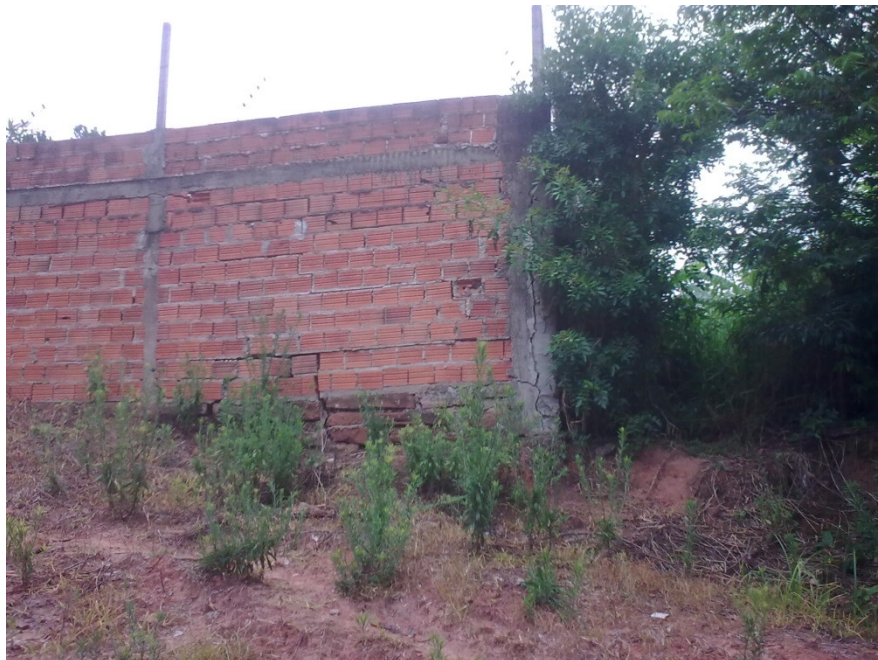
Fotografia 3 – Trincamento em muro existente no terreno ao lado do terreno estudado
