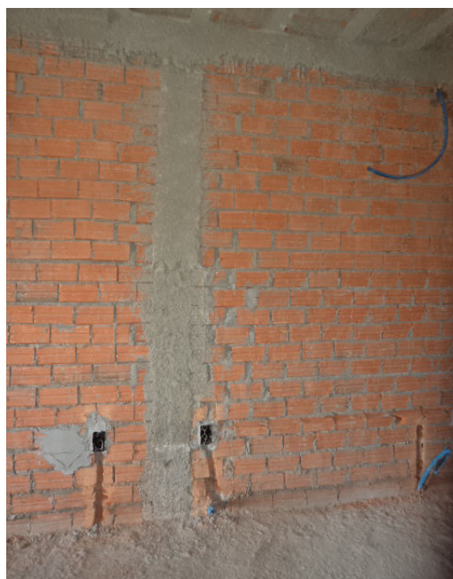
Figura 44 – Pilar com marcas de emendas de concretagem, mais ou menos a altura de 1,40 metros
