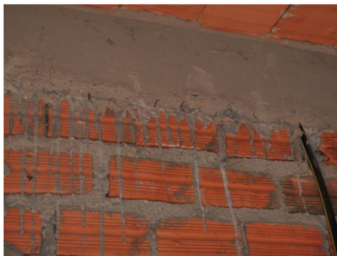
Figura 8 - Viga desformada sem encunhamento com a parede
