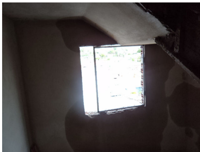
Figura 30 - Vãos de aberturas maiores que os contramarcos
