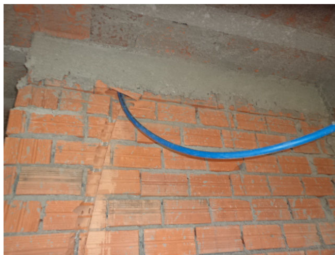
Figura 23 - Outra parede com blocos quebrados
