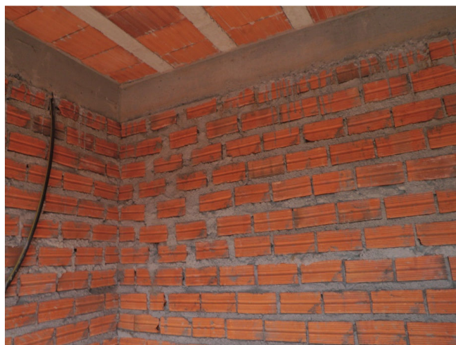
Figura 24 - Paredes com grande variabilidade nas espessuras das juntas
