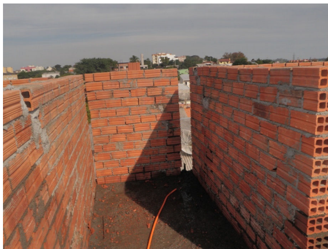
Figura 36 - Parede erguida até a altura de 1,40 metros com esperas para a construção dos pilares
