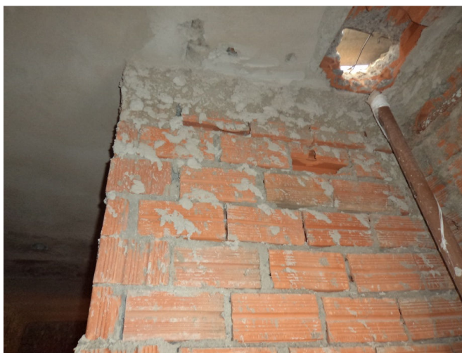
Figura 21 - Desalinhamento do encontro das paredes e blocos quebrados
