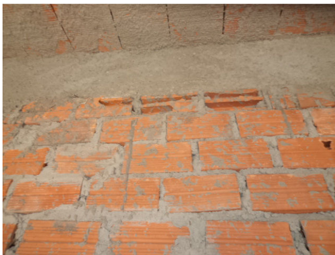
Figura 22 - Blocos nos topos das paredes quebrados e fiadas desalinhasdas
