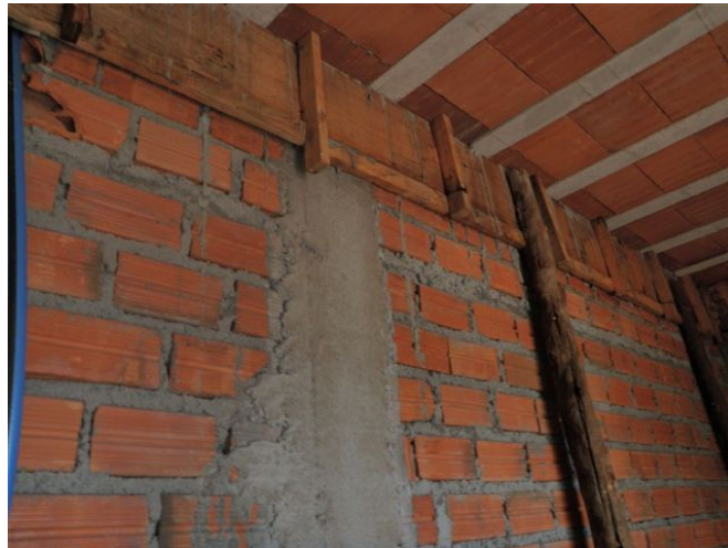
Figura 7- Viga desformada sem encunhamento com a parede
