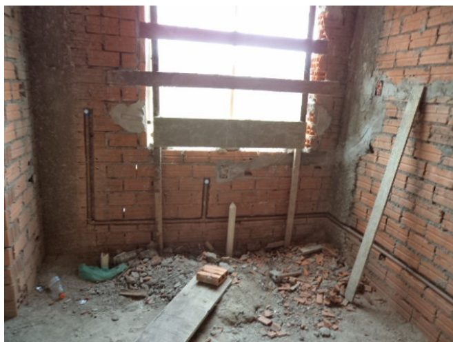
Figura 54 - Rasgos horizontais e verticais na alvenaria de vedação para instalações hidrossanitárias
