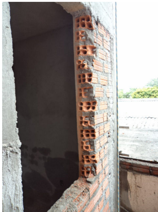
Figura 29 - Cantos de blocos quebrados
