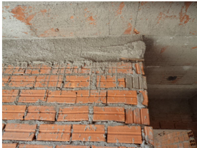
Figura 27 – Viga com pedaços de madeira prejudicando sua geometria
