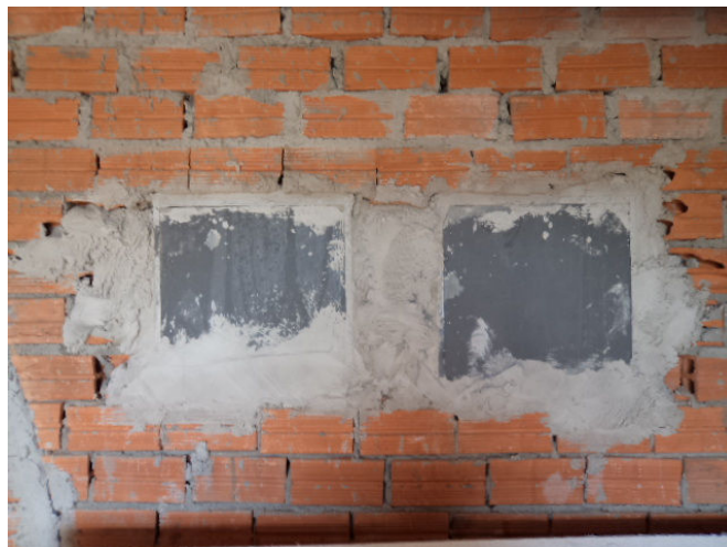
Figura 25 - Espaços de juntas sem preenchimento de argamassa
