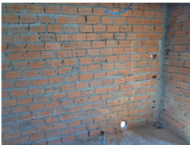
Figura 20 - Paredes sem padronização de execução
