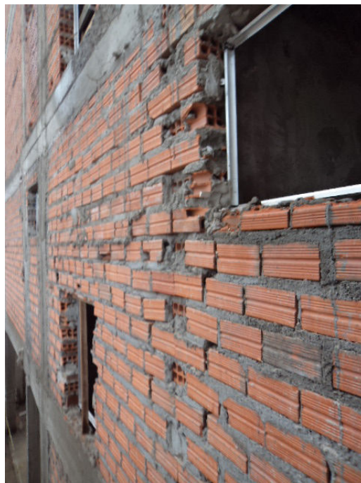
Figura 28 - Alvenaria mal executada e com quebra na lateral da janela
