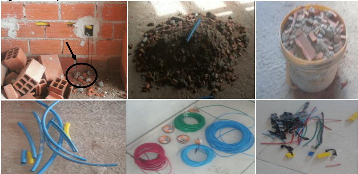
Figura 35: Desperdícios de materiais obra 3.
