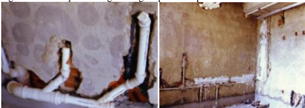
Figura 2: Tubulações de esgoto e água quente na parede.
