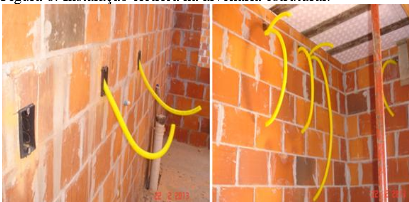
Figura 6: Instalação elétrica na alvenaria estrutural.
