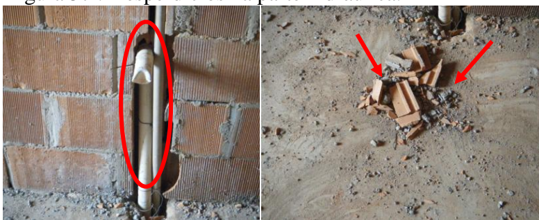
Figura 57 : Desperdícios na parte hidráulica.
