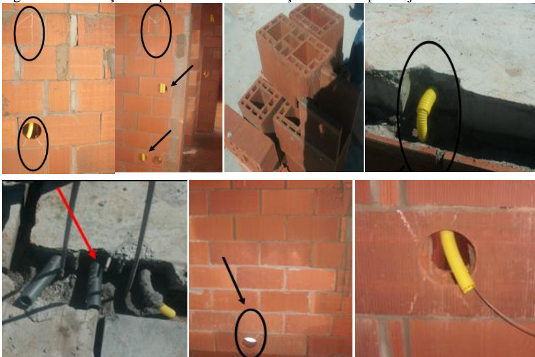
Figura 43: Marcação nas paredes e demonstração de dutos pela laje na obra 5.
