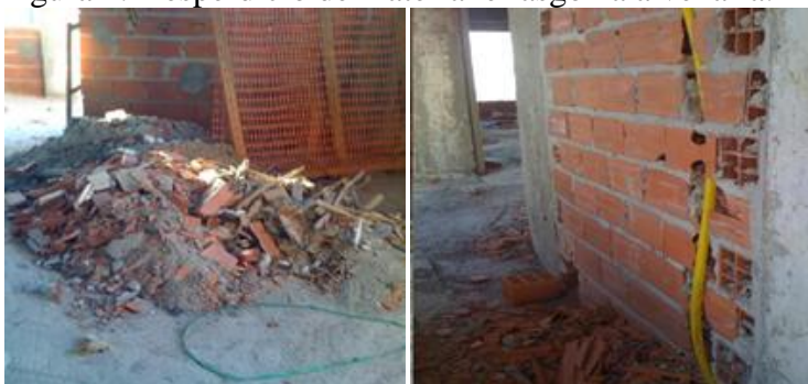
Figura 1: Desperdício de material e rasgo na alvenaria.
