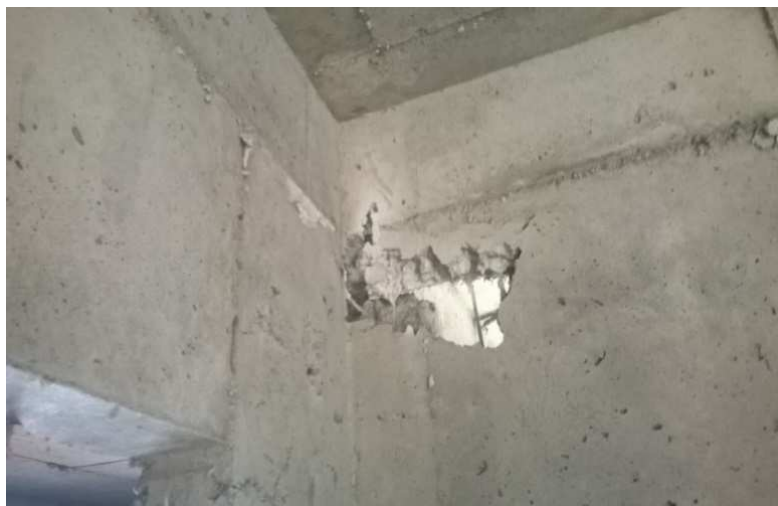
Figura 38: Falha de concretagem no canto de parede.
