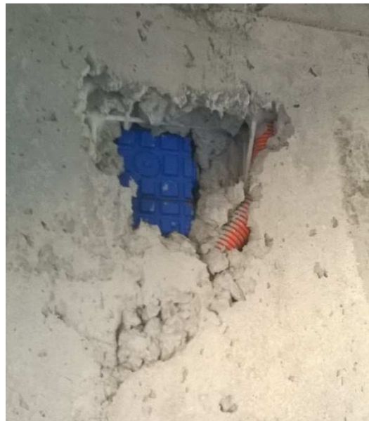
Figura 40: Instalações elétricas aparente por falha de concretagem.
