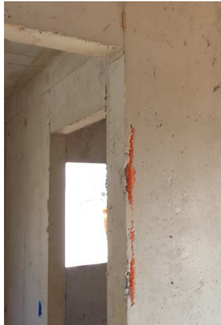
Figura 41: Instalações elétricas mal posicionadas.
