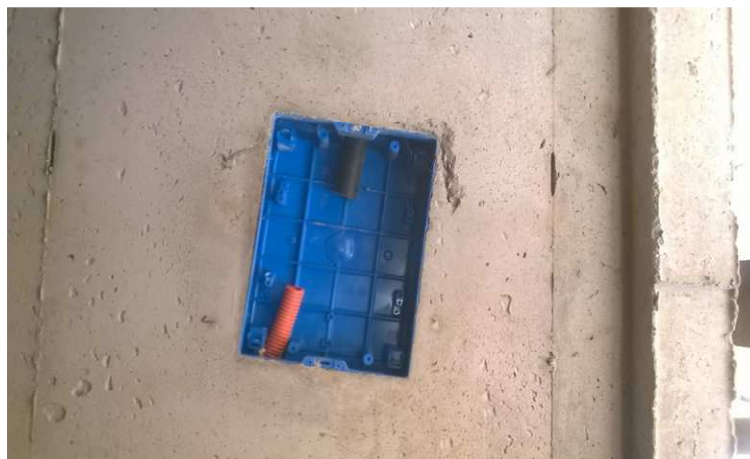
Figura 42: Instalações com posicionamento errado.
