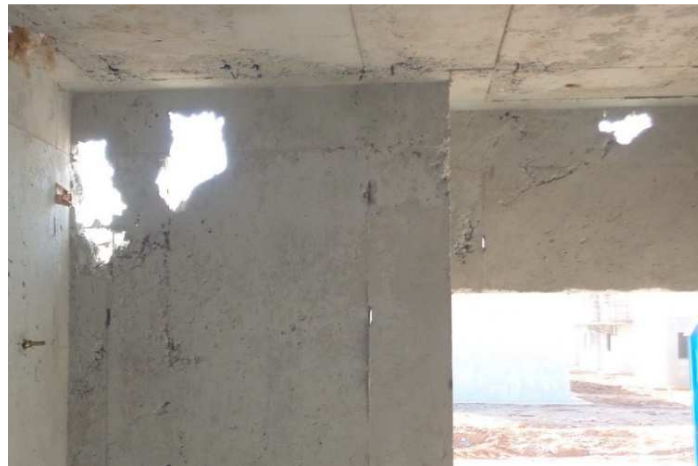
Figura 39: Falhas de concretagem nas paredes.
