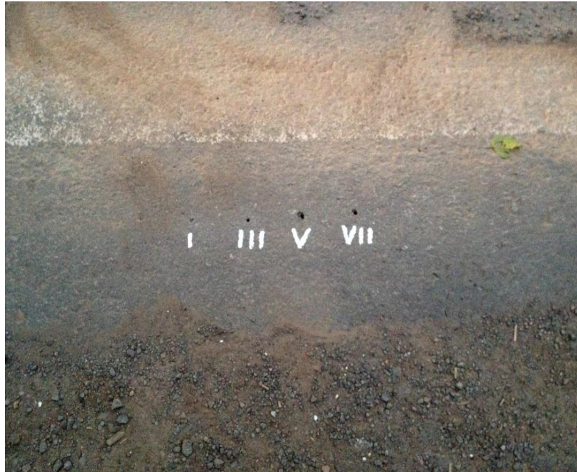
Figura 11 - Ponto 2 (na sombra) com os respectivos furos na rodovia
