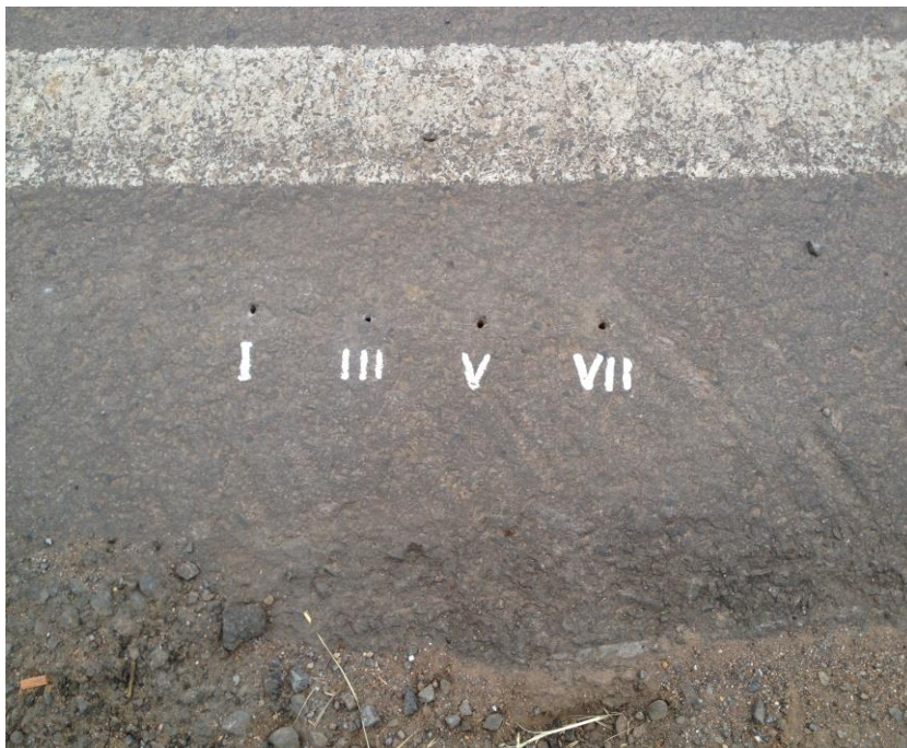
Figura 10 - Ponto 1 (ao sol) com os respectivos furos na rodovia
