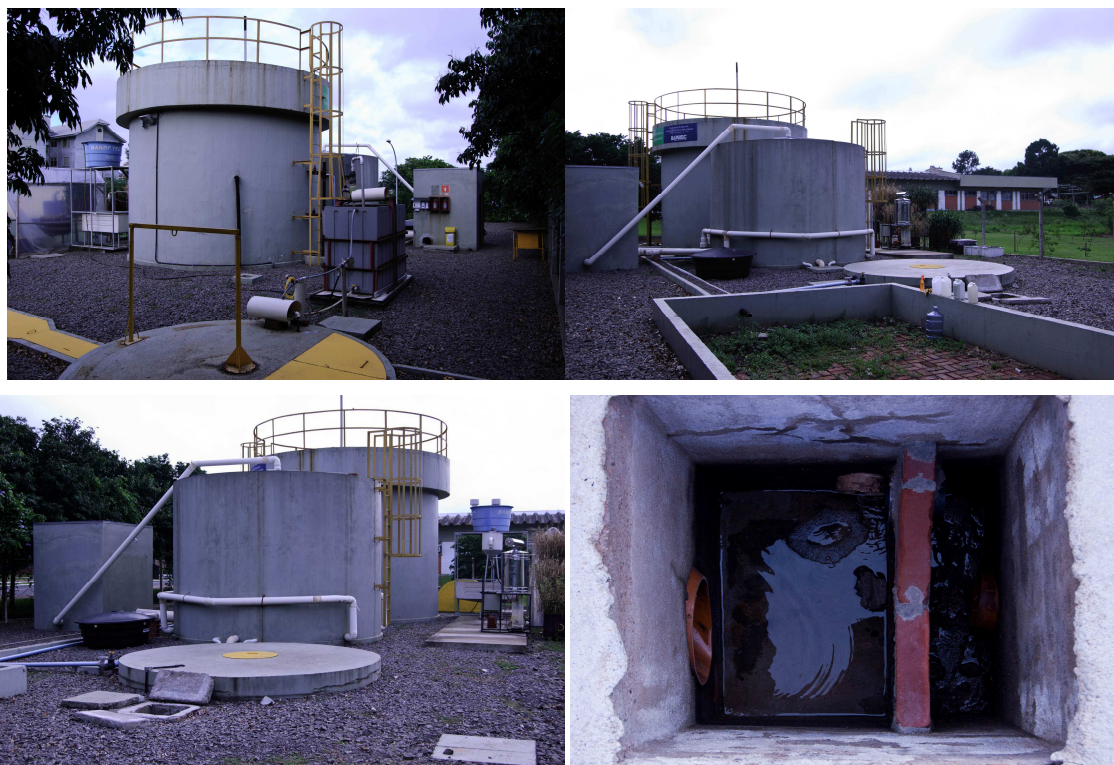
Figura 10: Vista geral da ETE-UNISC, no canto inferior direito o detalhe para a caixa de inspeção, de onde foram retiradas as amostras de efluente.
