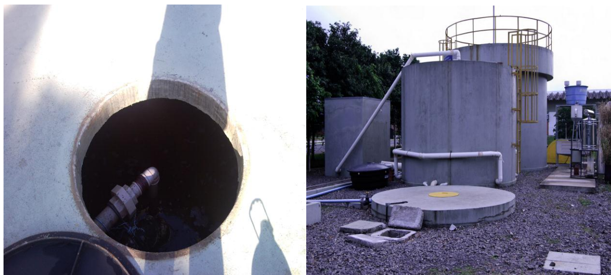
Figura 8- Vista geral da ETE-UNISC, no canto inferior direito o detalhe para a caixa de inspeção, de onde foram retiradas as amostras de efluente.
