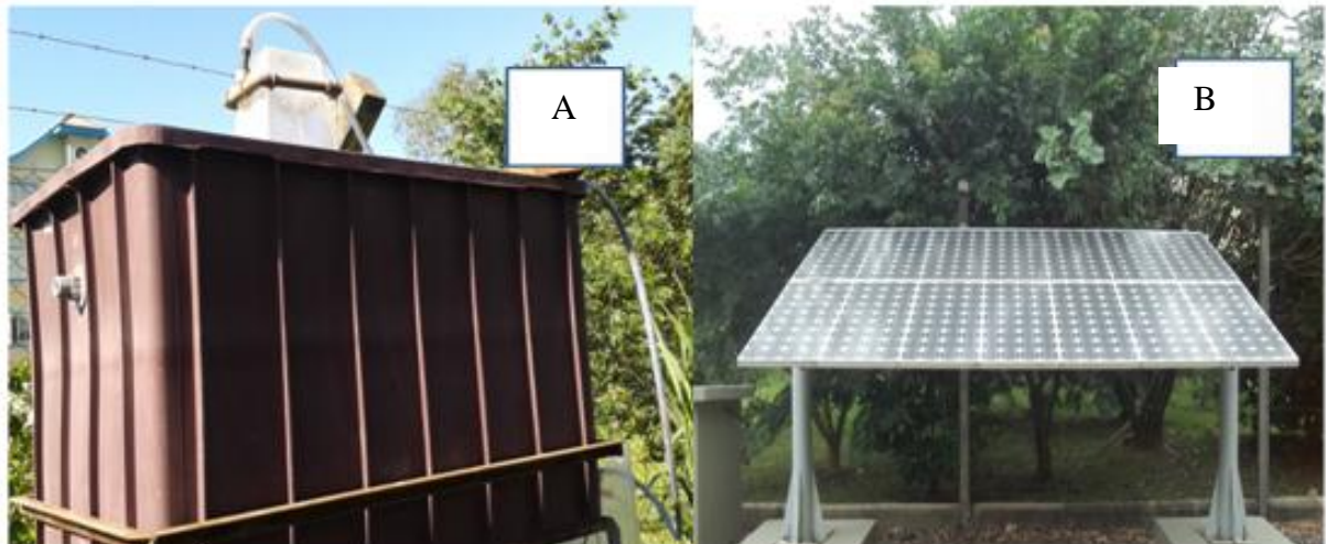
Figura 5: Sistema de tratamento com recirculação do tipo cone (A), célula fotovoltaica (B).
