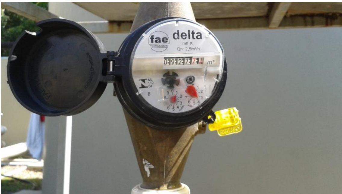
Figura 10: Hidrômetro para controle de vazão e ajustes do abastecimento dos sistemas de monitoramento.
