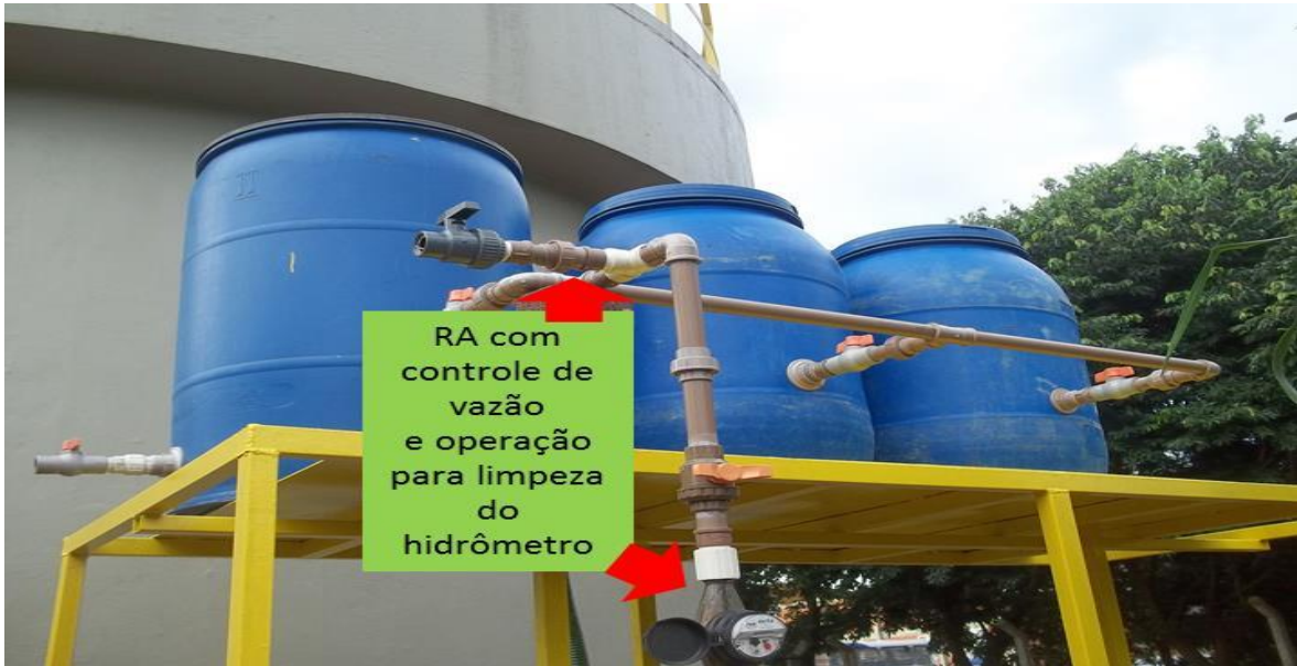
Figura 11: Sistema de armazenamento e abastecimento RA, com controle de vazão e operação.
