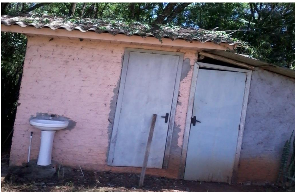
Figura 10: Abrigo de armazenamento externo de resíduos.
