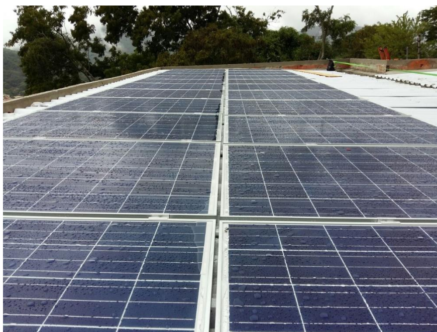
Figura 02: Placas de energia solar.
