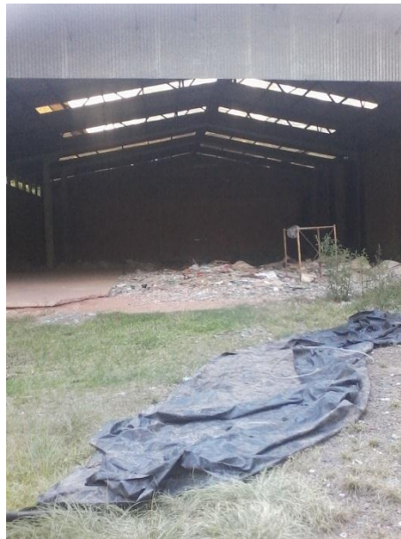
Figura 8 – Galpões no bairro Faxinal, próximo ao Presídio Regional (1)
