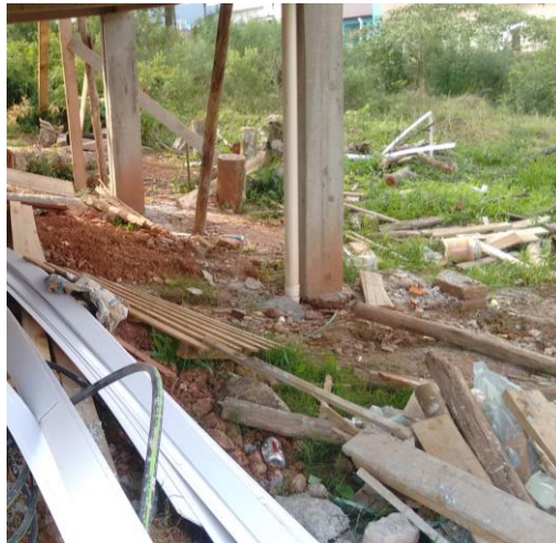
Fotografia 19 – Sobras de material e entulho
