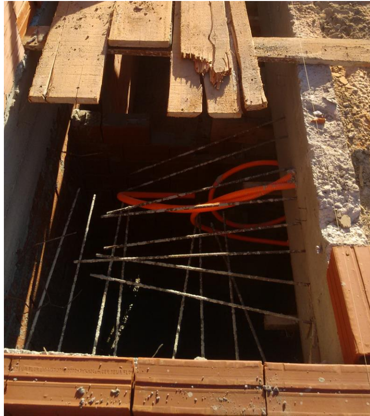
Fotografia 10 – Abertura no piso em desacordo com as normas
