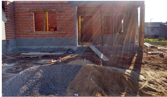
Fotografia 22 – Armazenamento de areia e brita diretamente sobre o solo
