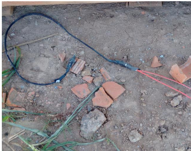
Fotografia 15 – Conductor sem proteção mecânica
