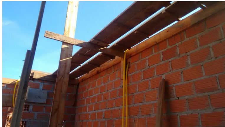
Fotografia 9 – Posto de trabalho em altura sem guarda corpo
