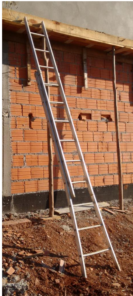
Fotografia 8 – Escada suscetível a acidentes
