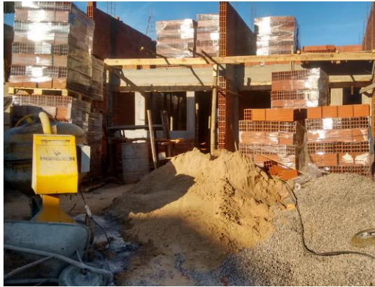
Fotografia 23 – Desorganização e empilhamento incorreto de tijolos
