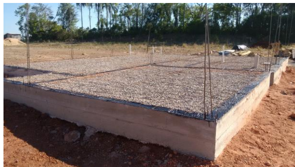
Fotografia 6 – Pontas de aço desprotegidas
