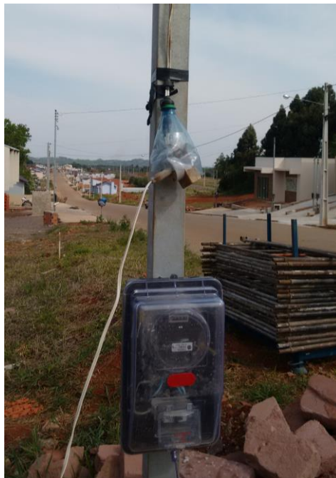
Fotografia 13 – Entrada de energia elétrica
