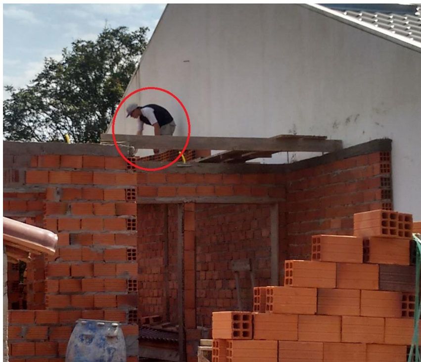
Fotografia 17 – Trabalho em altura sem utilização de EPI
