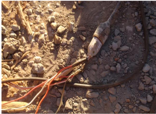
Fotografia 14 – Ramificações e emendas
