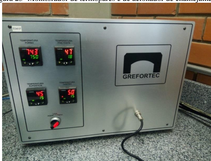
Figura 23- Monitorador de termopares e de acionador de chamejamento.
