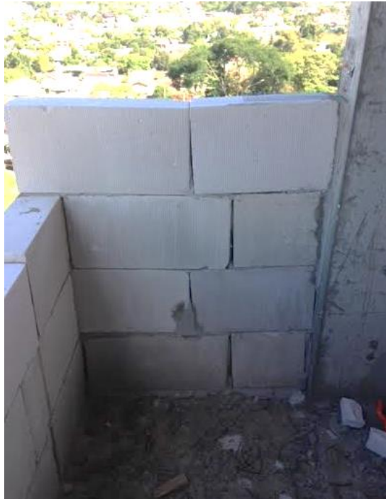
Figura 14 – Alvenaria desalinhada horizontalmente
