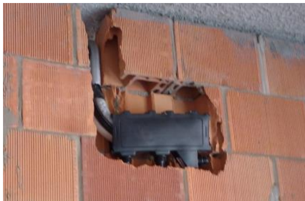
Figura 48 – Espera de ar condicionado
