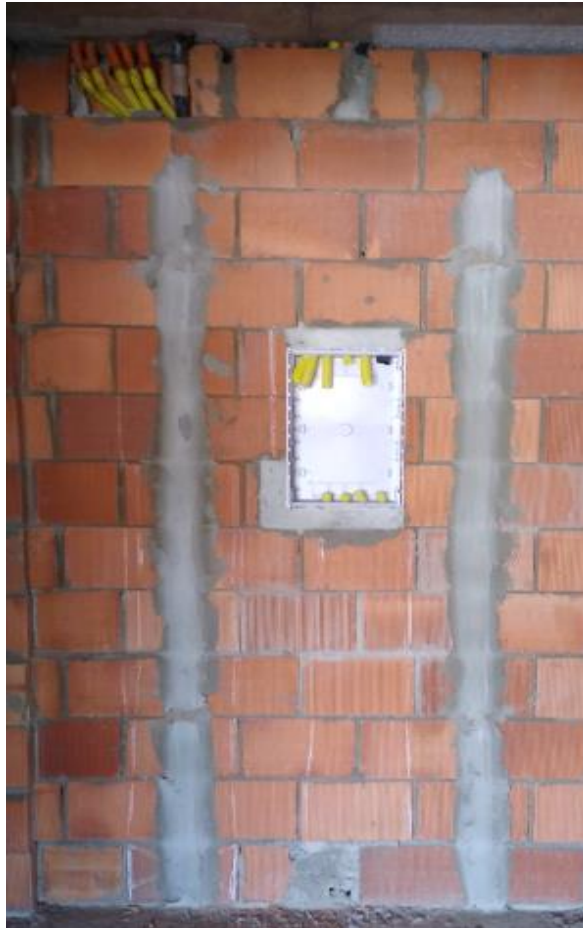
Figura 47 - CD e eletrodutos embutidos na alvenaria
