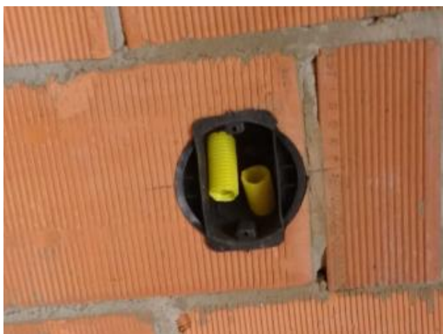
Figura 49 - Caixa de luz em formato circular
