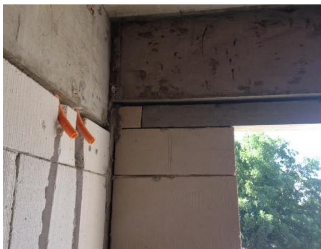
Figura 20 – Encunhamento com junta abaixo do recomendável
