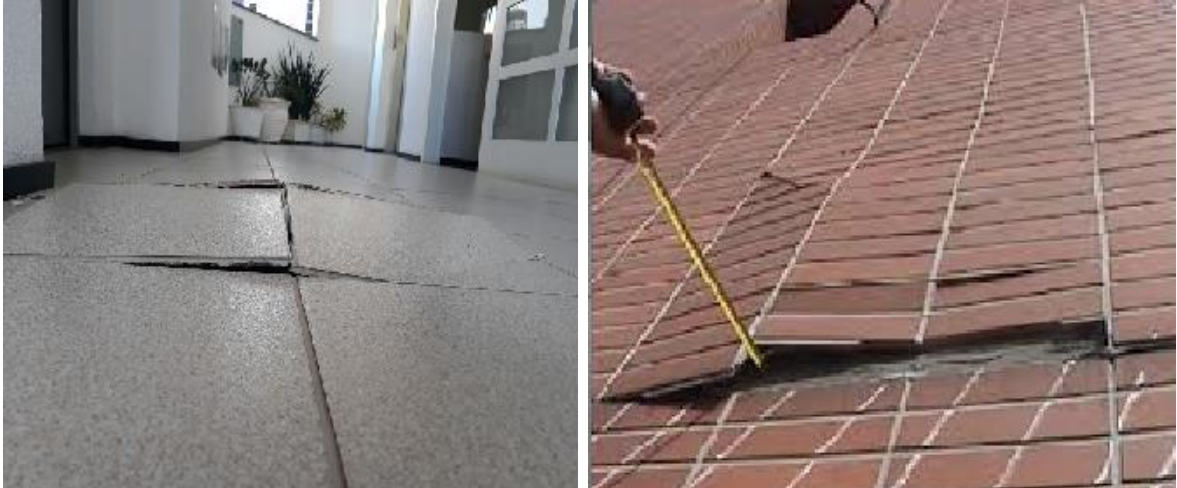
Figura 15 - Descolamento de placas cerâmicas
