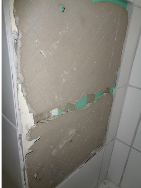
Figura 21 - Superfície de aplicação do revestimento descolado
