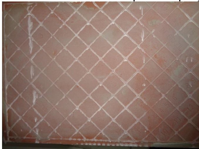
Figura 22 - Placa cerâmica descolada da superfície de aplicação
