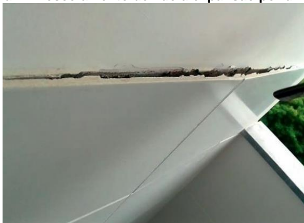
Figura 1 - Descolamento devido à expansão por umidade
