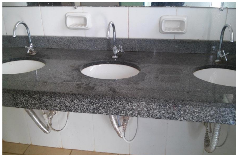
Figura 4 – Torneiras Banheiro Masculino e Feminino
