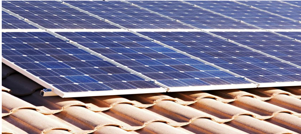
Figura 9: Painel Placa Fotovoltaica
