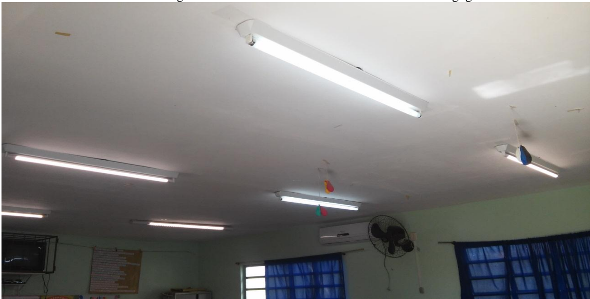
Figura 8: Luminárias das salas de aula do Bloco Pedagógico:
