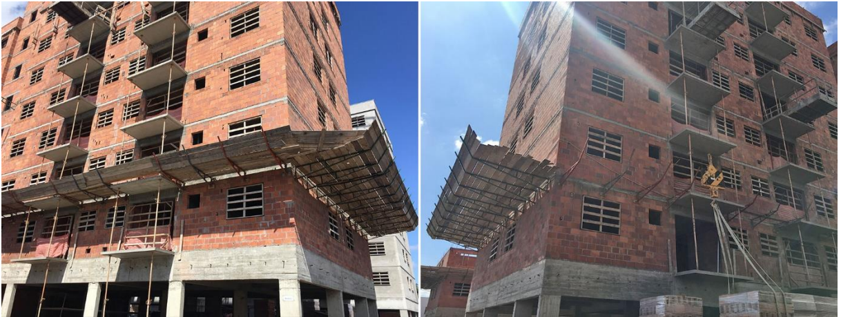
Figura 23 - Plataforma de proteção
