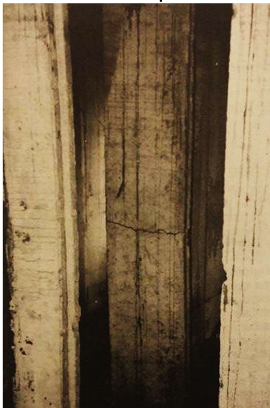
Figura 8 – Trincas horizontais a meia altura de pilar pré-moldado submetido à flexocompressão
