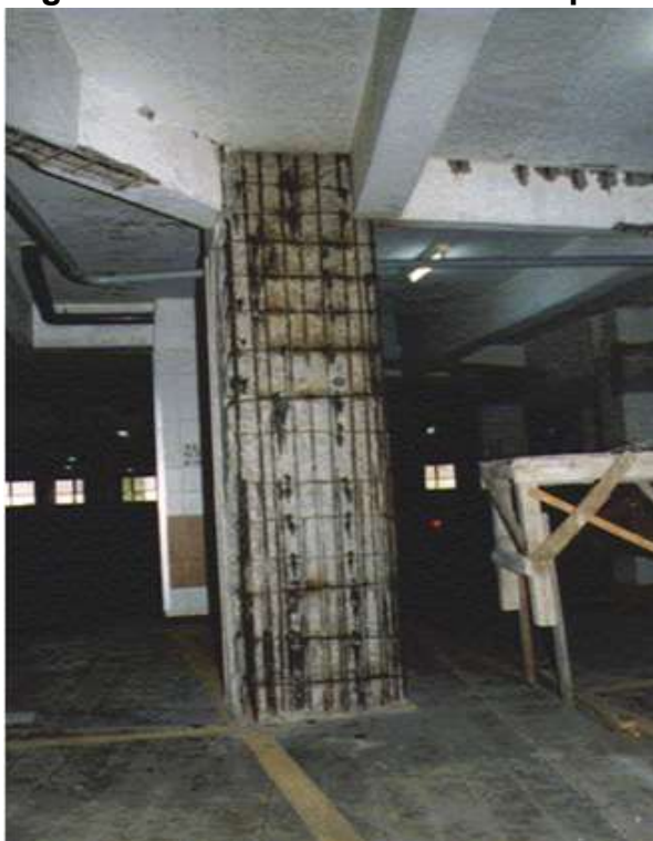
Figura 19 – Corrosão generalizada de armaduras em pilar de concreto armado
