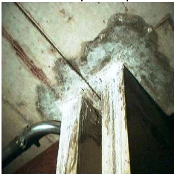
Figura 18 – Eflorescência no topo de um pilar de concreto armado
