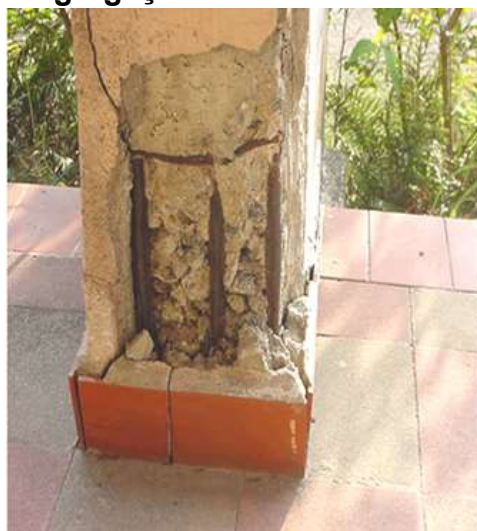
Figura 17 – Desagregação do concreto da base de um pilar
