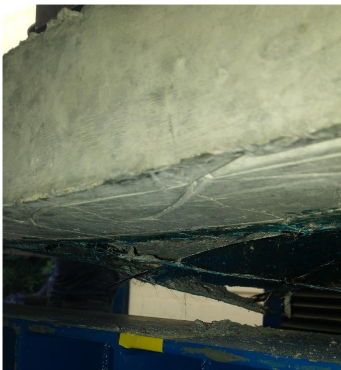
Figura 29 - Ruptura da laje 2
