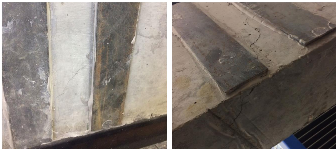
Figura 65 - Fissuras do ensaio complementar (Teste 07)
