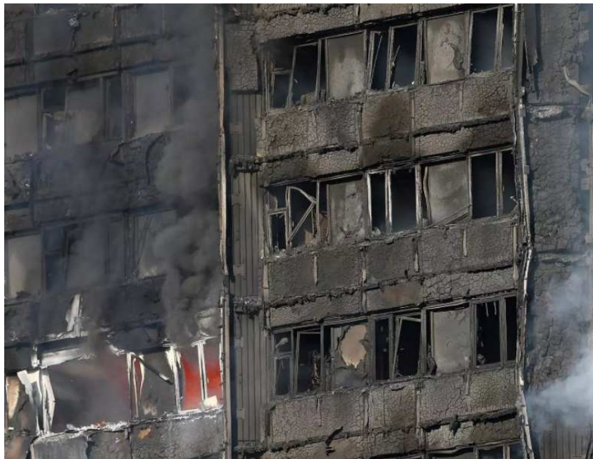
Figura 18 – Detalhe de fachada incendiada da Grenfell Tower
