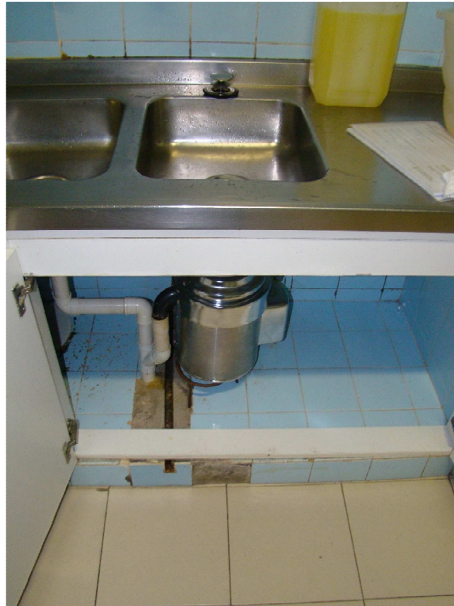
Figura 12: Detalhe do triturador de alimentos instalado na cozinha do H1
