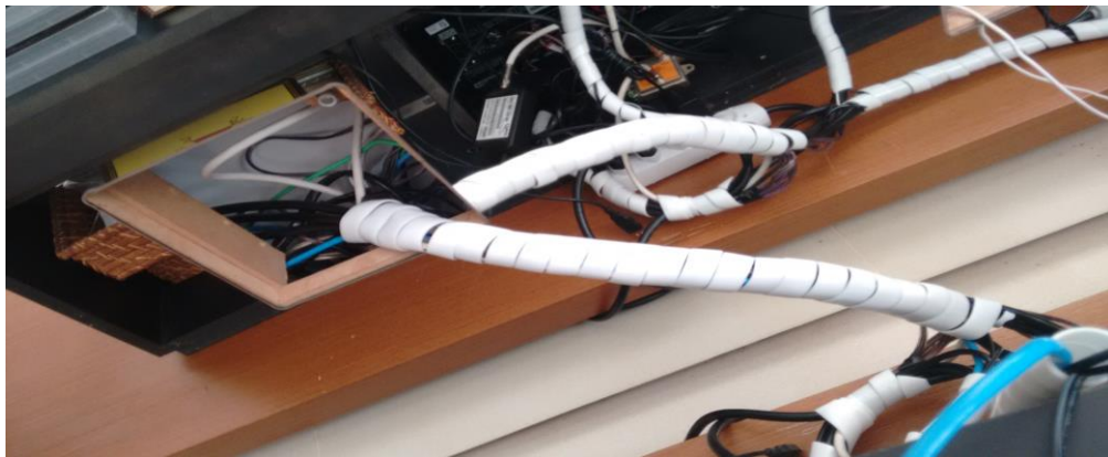
Figura 41 - Interferência do cabo de força junto ao cabo de rede extraída de ambiente real.
