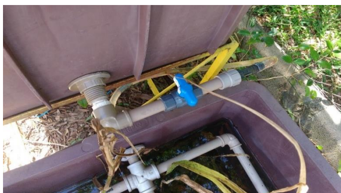
Figura 11 - Detalhe da saída do WC 1 conectado à entrada do WC 2 através de cano PVC 12,7 mm de diâmetro e válvula borboleta.
