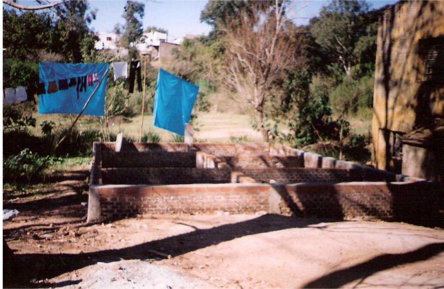
FIGURA 19 – Construção ilegal à frente da Canhada do Sapo, Passo do Onze
