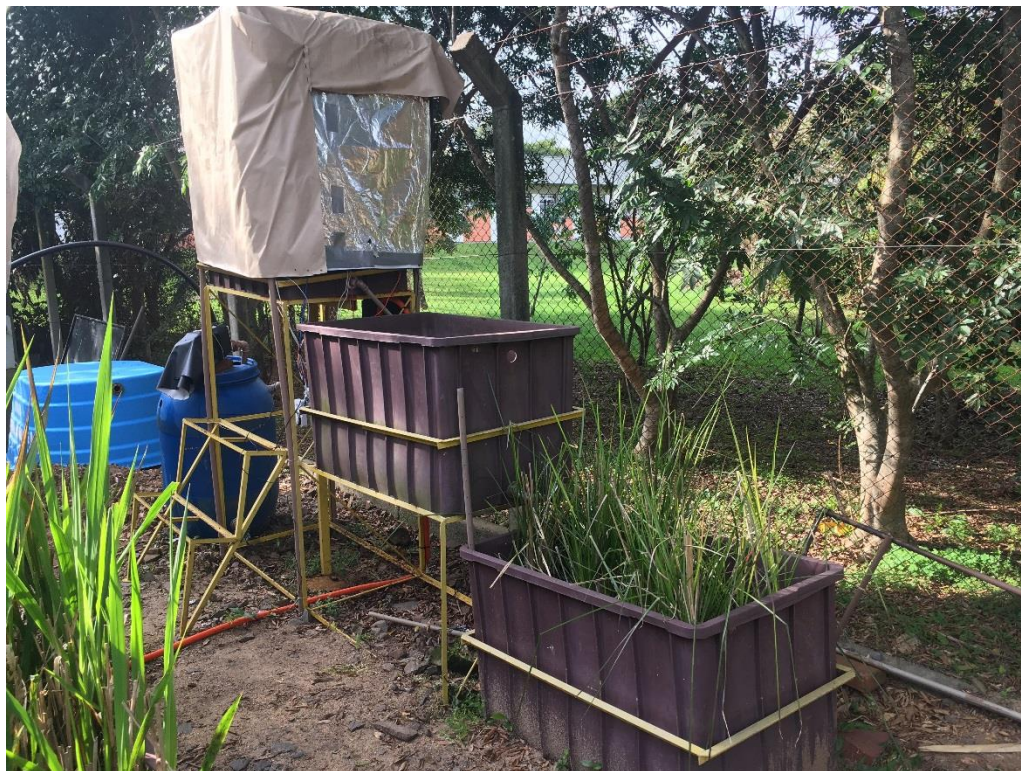
Figura 4 – Sistema de tratamento de efluentes proposto, composto por três caixas de PEAD com 200 litros cada.
