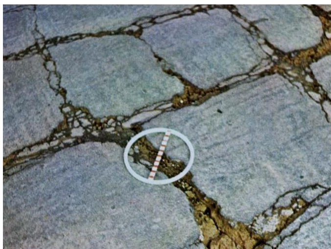
Figura 7: Trinca interligada tipo “Bloco”
