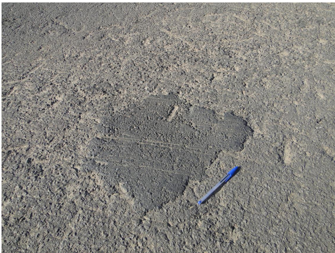
Figura 31: Remendos superficiais pouco compactados
