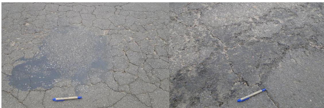
Figura 30: Remendos superficiais na pista
