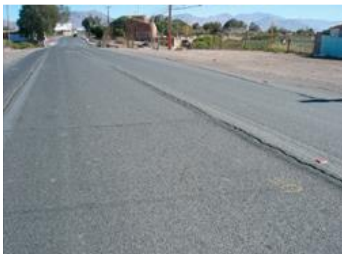
Figura 5: Trinca isolada de retração
