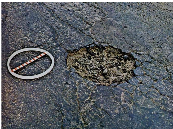
Figura 13: Panela ou buraco
