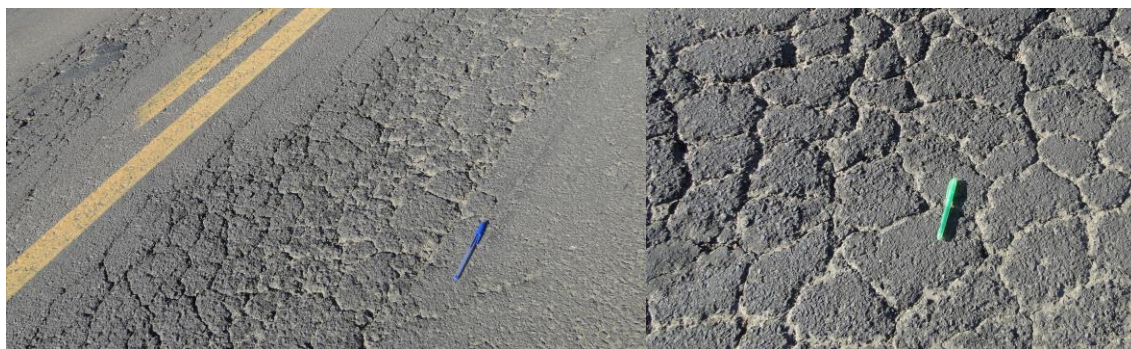
Figura 26: Trincas existentes no pavimento analisado
