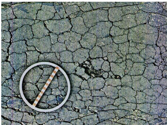
Figura 6: Trinca interligada tipo “Couro de jacaré”
