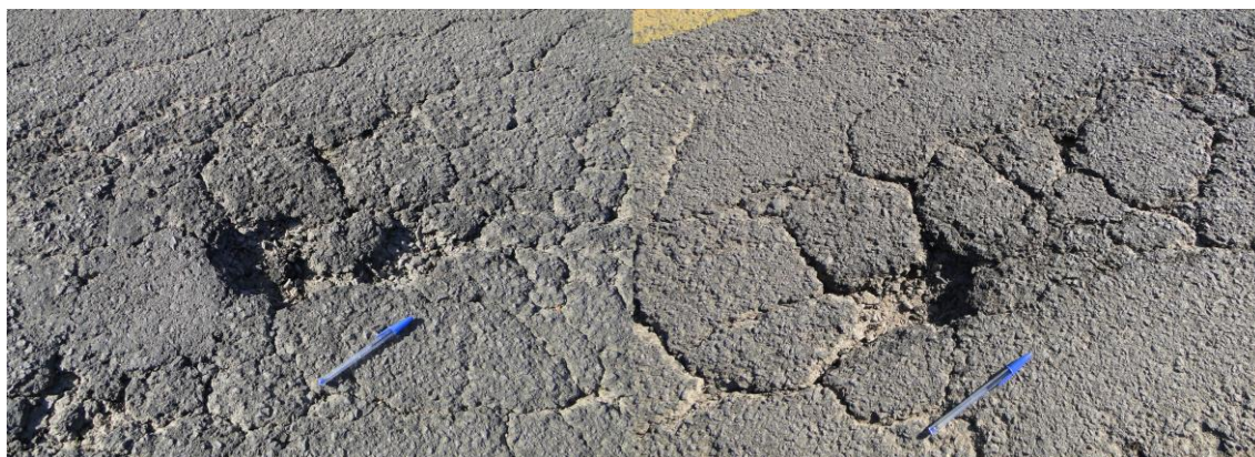
Figura 28: Início dos buracos originados de trincas
