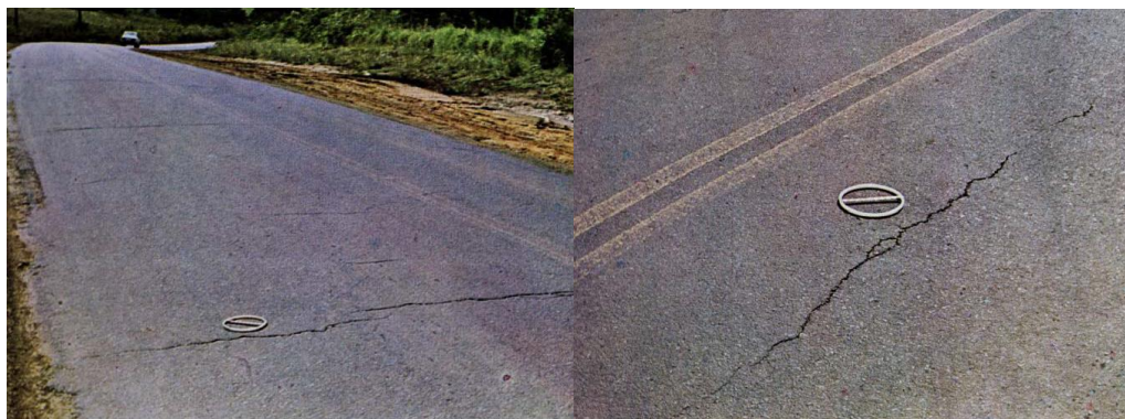
Figura 4: Trinca isolada transversal e longitudinal, respectivamente
