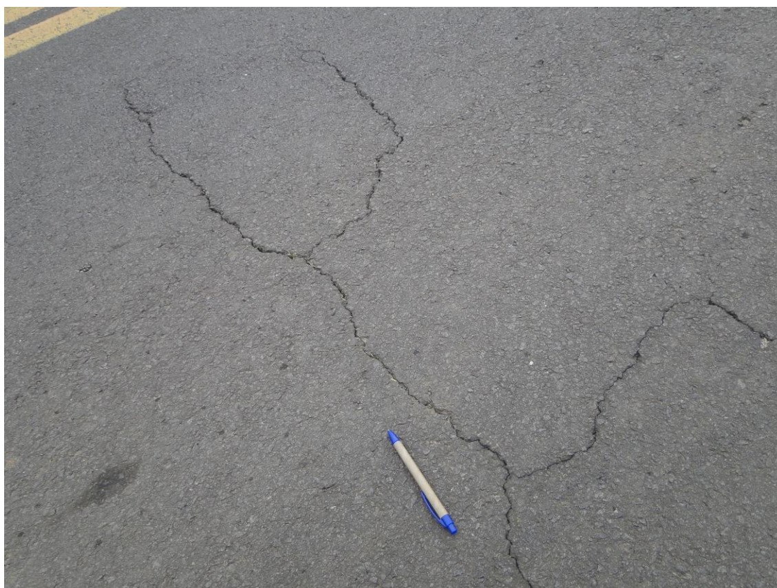
Figura 27: Trincas isoladas existentes no pavimento
