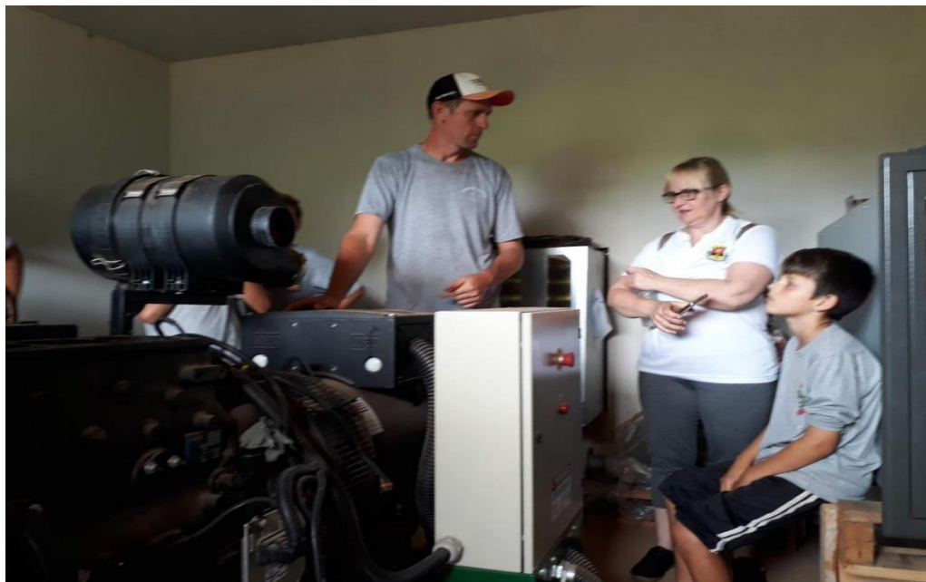
Figura 62 - Produtor: explicação técnica do sistema de energia com biogás
