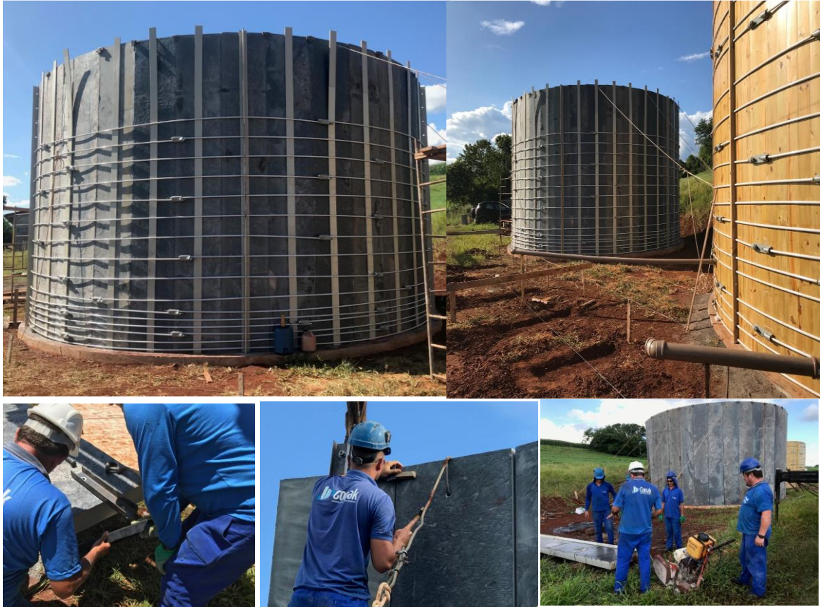
Figura 31 - Biodigestor em pedra Ardósia
