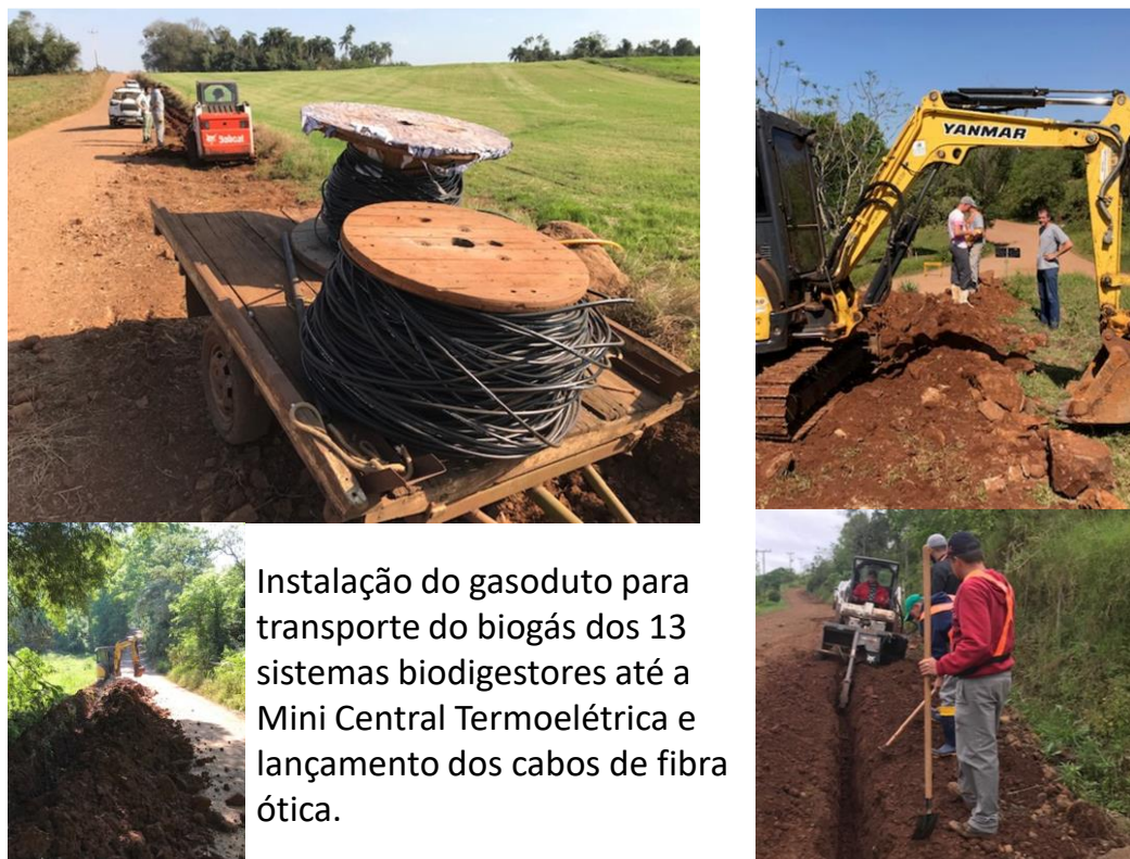
Figura 28 – Gasoduto e cabos de fibra ótica – interligação sistema
