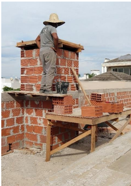
Fotografia 15: Trabalhador sem EPI
