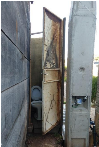
Fotografia 18: Instalações sanitárias da obra 3
