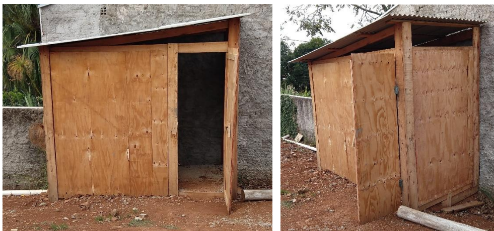
Fotografia 11: Instalações sanitárias da obra 2
