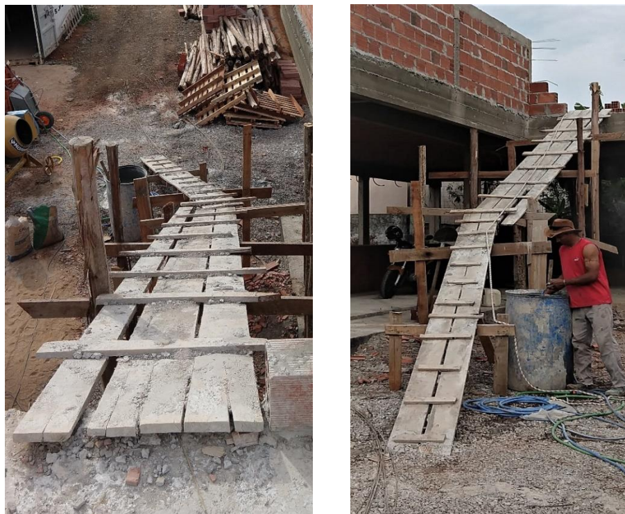
Fotografia 12: Ausência de corrimão na escada
