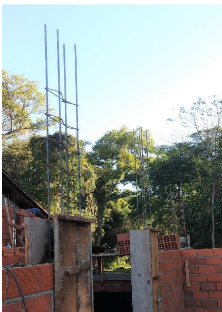
Fotografia 20: Espera de pilares sem proteção
