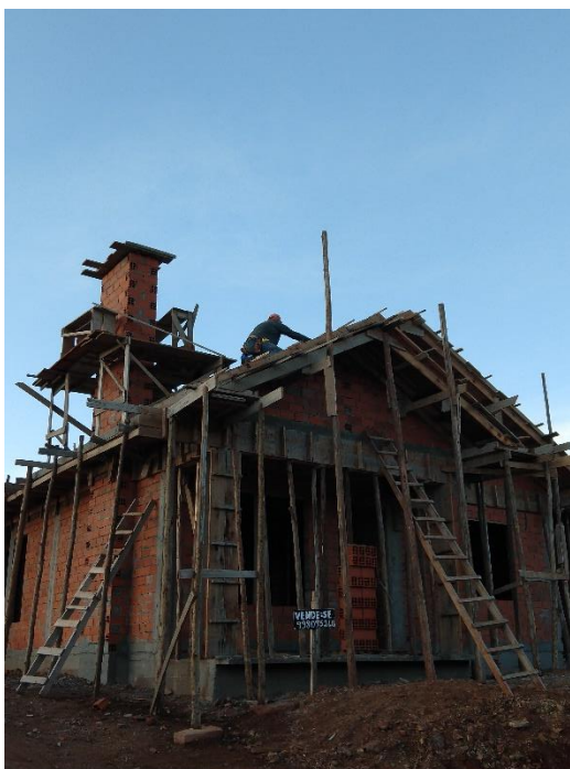
Fotografia 9: Trabalhador sem equipamentos de proteção individual
