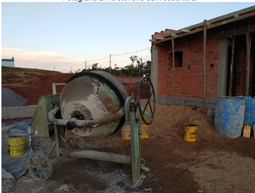
Fotografia 21: Betoneira sem cobertura.
