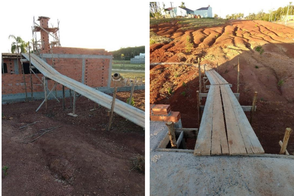
Fotografia 4: Rampa da obra 1 sem corrimão
