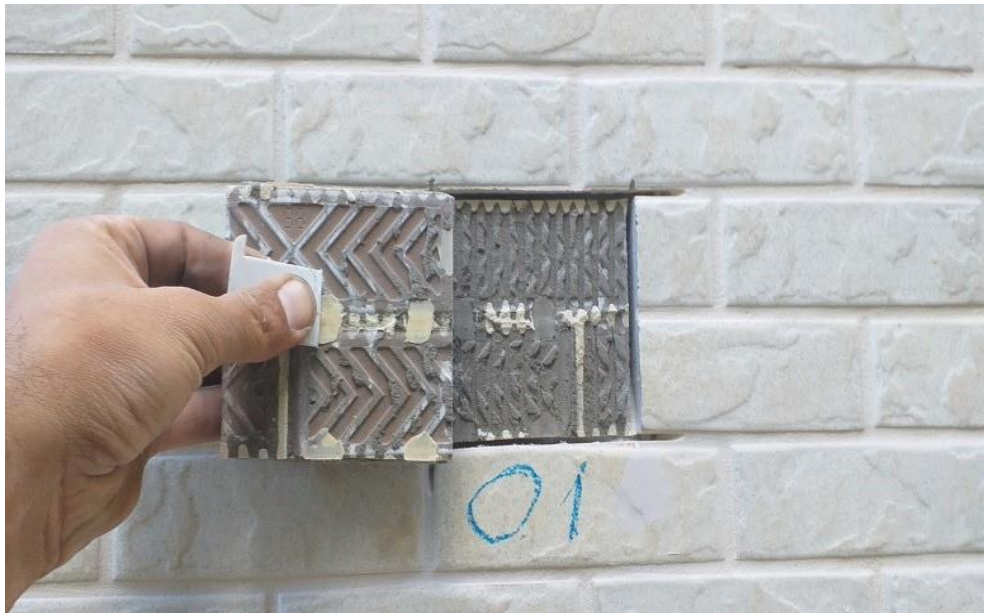
Figura 46 - Corpo de prova em local com som cavo – Ruptura na interface argamassa colante/placa cerâmica
