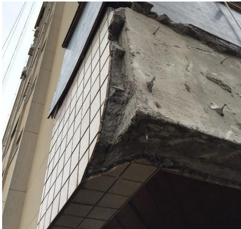
Figura 25 - Descolamento cerâmico junto à base
