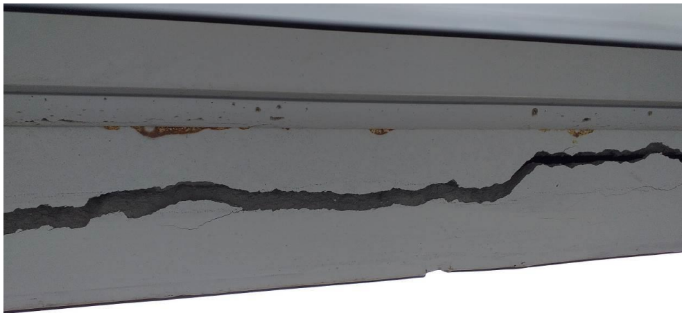
Figura 57 - Fissura no revestimento, indicando região com risco de queda
