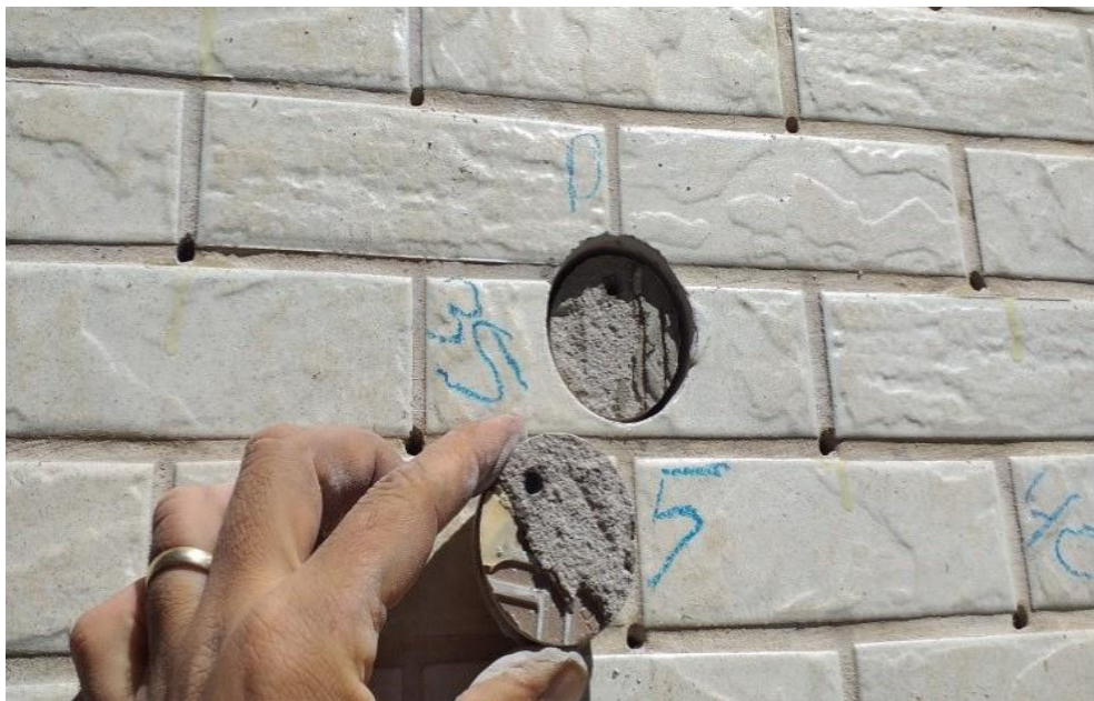
Figura 73 - Ensaio de arrancamento protótipo C - Ruptura na interface argamassa/cola
