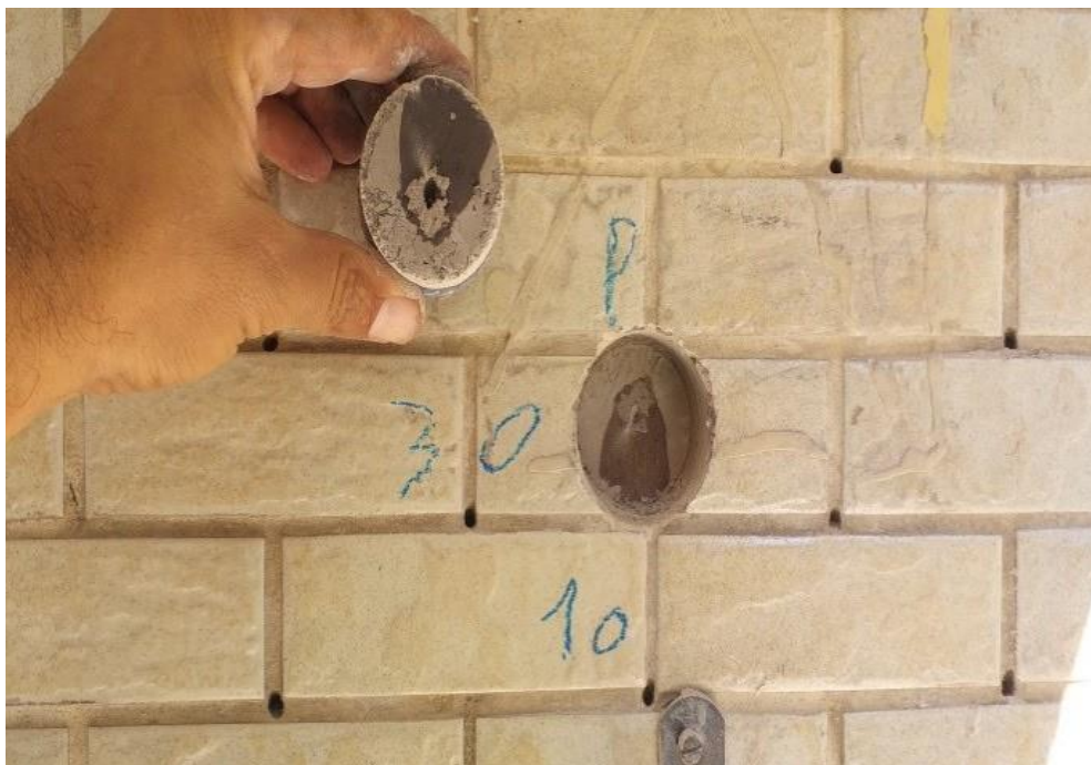
Figura 77 - Ensaio de arrancamento protótipo D - Ruptura na interface substrato/chapisco
