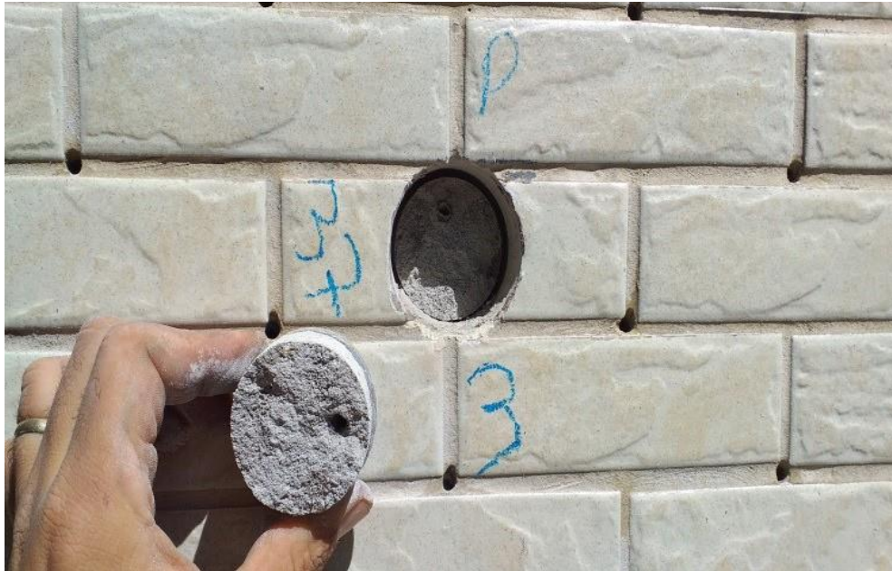
Figura 72 - Ensaio de arrancamento protótipo C - Ruptura na argamassa de emboço
