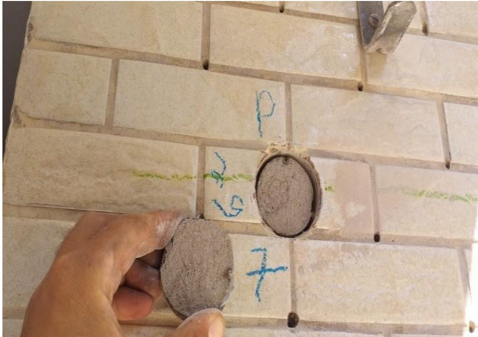
Figura 76 - Ensaio de arrancamento protótipo D - Ruptura na argamassa de emboço
