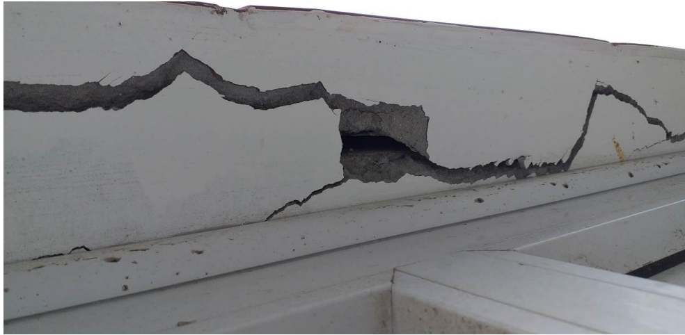
Figura 56 - Revestimento com risco de queda pela ruptura da argamassa junto à base
