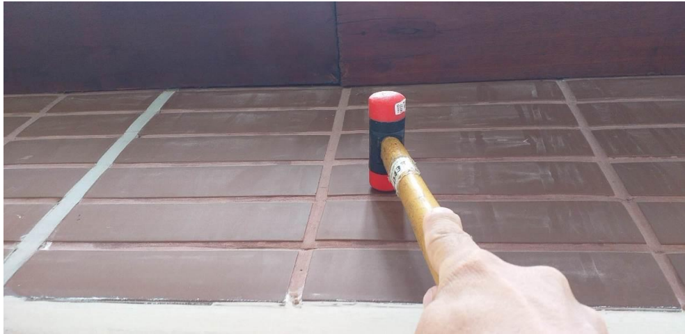
Figura 52 - Teste de percussão na fachada para verificação de som cavo
