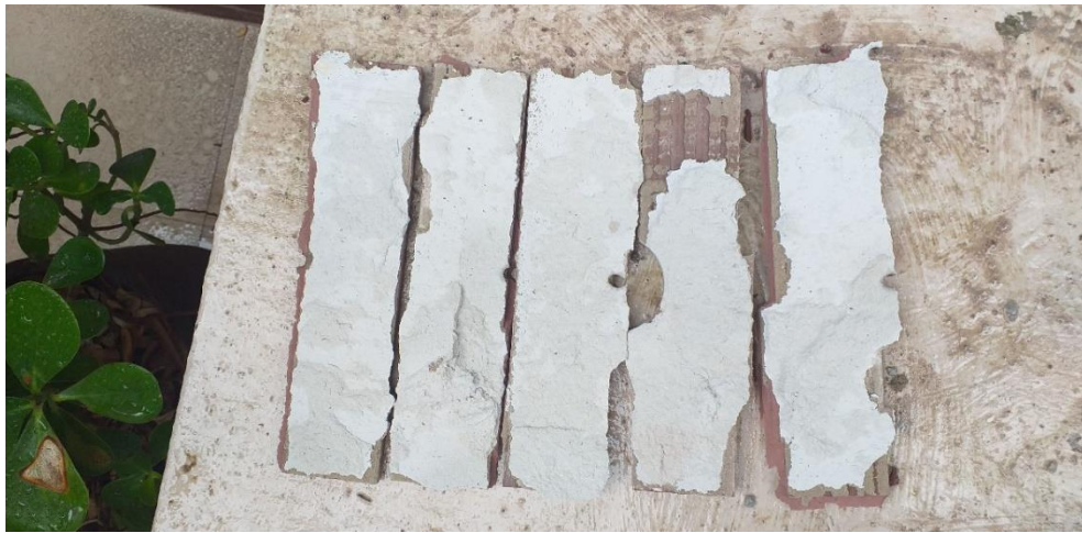
Figura 86 - Protótipos E e F - Peças cerâmicas removidas juntamente com a argamassa de emboço
