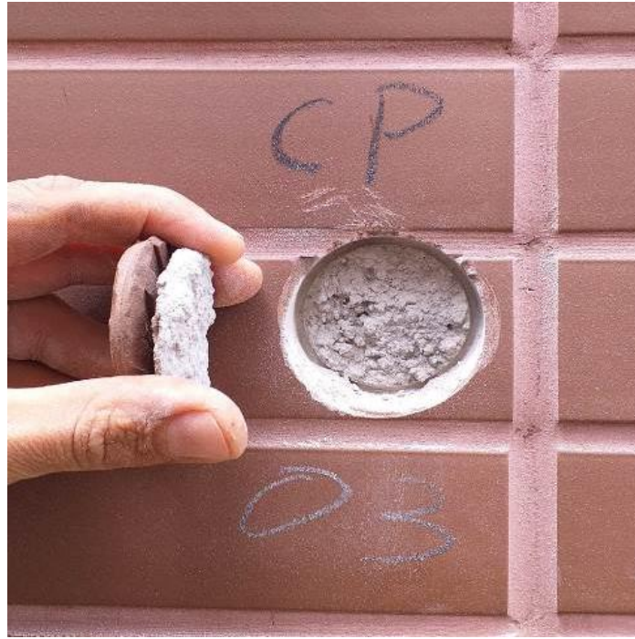
Figura 62 - Corpo de prova – Descolamento entre argamassa de emboço e chapisco
