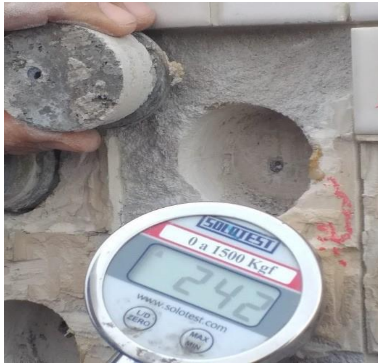
Figura 69 - Ensaio de arrancamento protótipo B – Ruptura na interface substrato/chapisco
