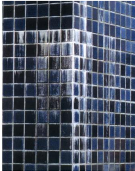
Figura 17 - Eflorescência em revestimento cerâmico
