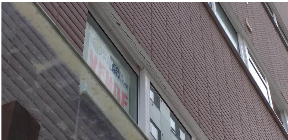
Figura 55 - Fissura decorrente de descolamento do revestimento argamassado da base
