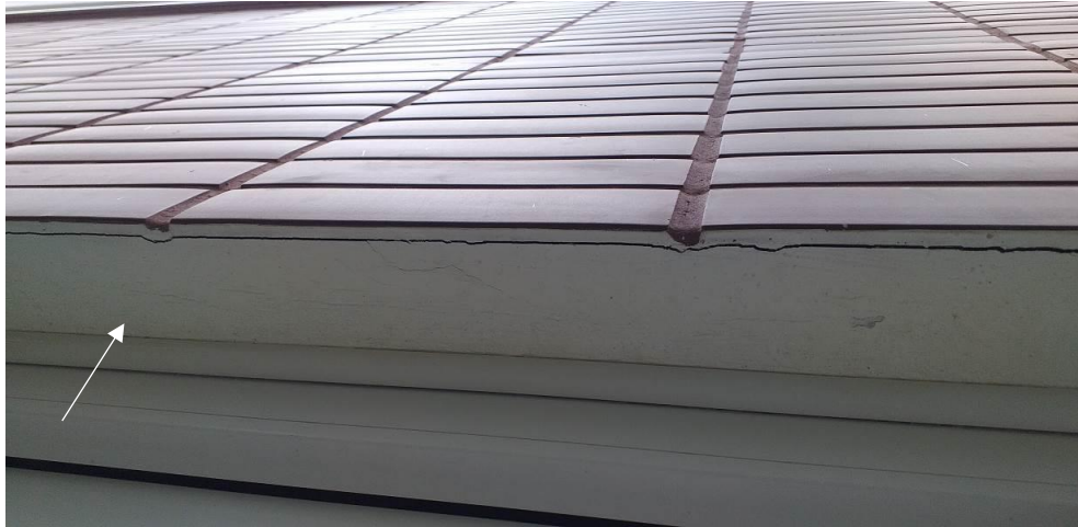
Figura 54 - Fissura decorrente do descolamento do revestimento cerâmico
