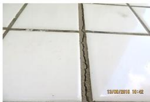
Figura 21 - Fissuras em argamassa de rejunte
