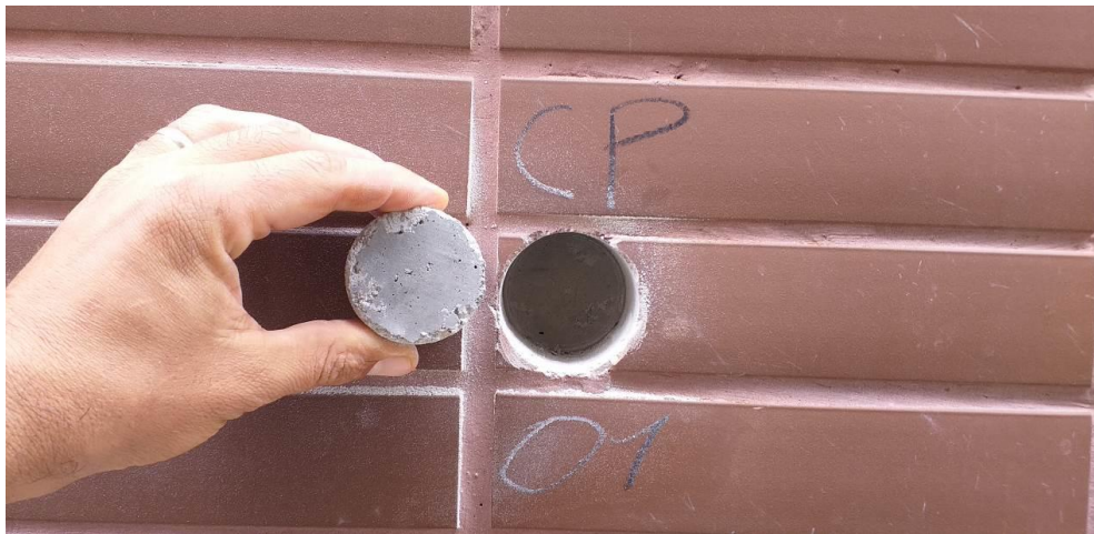
Figura 59- Corpo de prova – Descolamento entre chapisco e base
