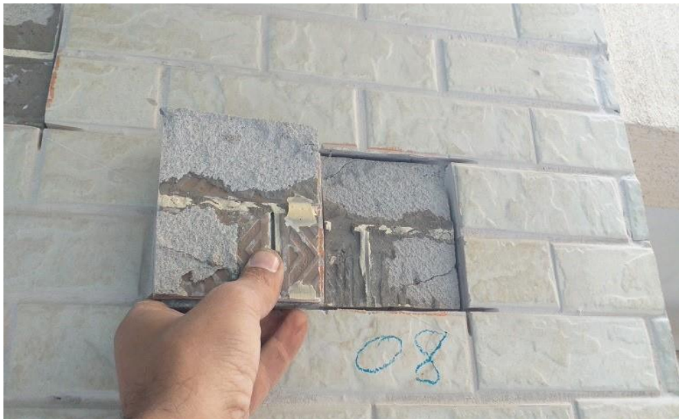
Figura 47 - Corpo de prova em local com som cavo – Ruptura na interface argamassa colante/emboço
