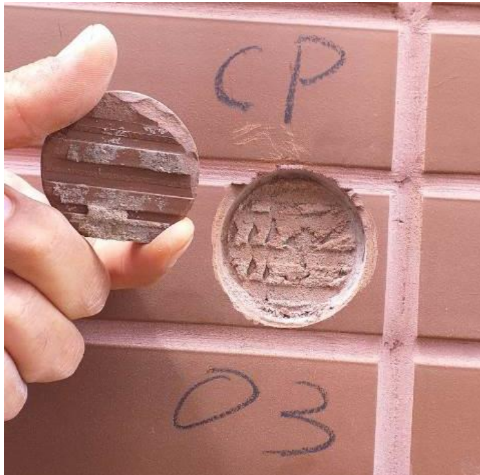
Figura 61 - Corpo de prova– Descolamento entre cerâmica e argamassa colante
