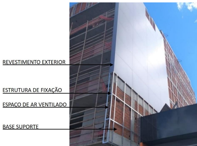
Figura 3 - Fachada com revestimento não aderido em Santa Cruz do Sul.
