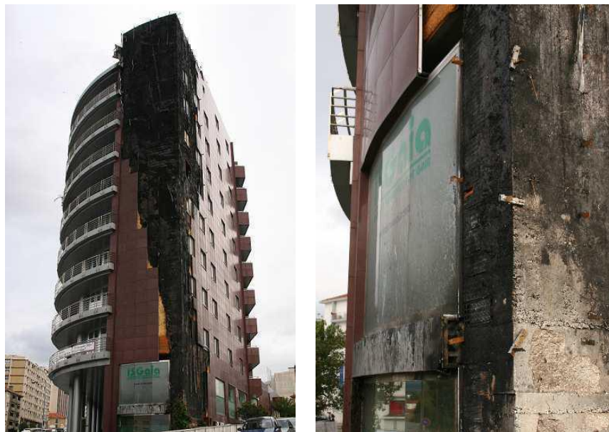
Figura 14 – Revestimento após o incêndio no edifício multifamiliar em Gaia.
