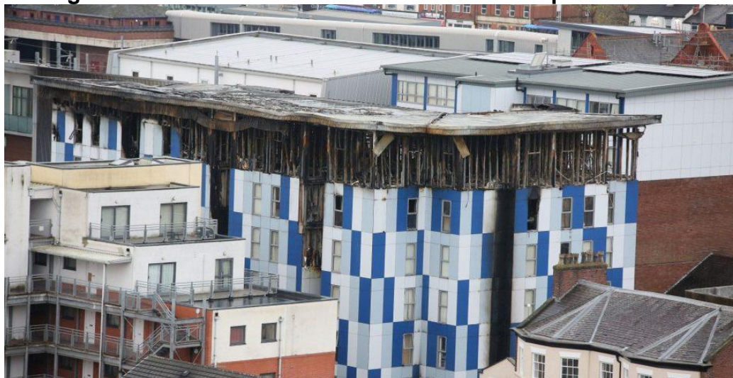
Figura 16 - Residência estudantil "The Cube" após incêndio.
