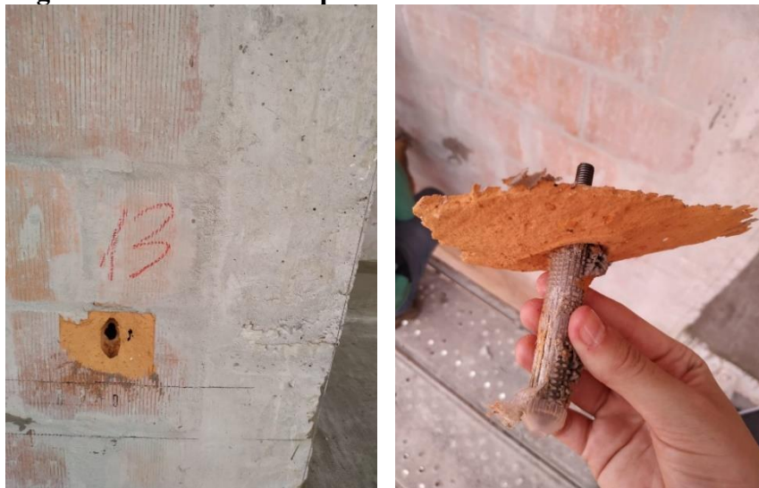
Figura 71 – Análise de ruptura ocorrida nos blocos de 7MPa
