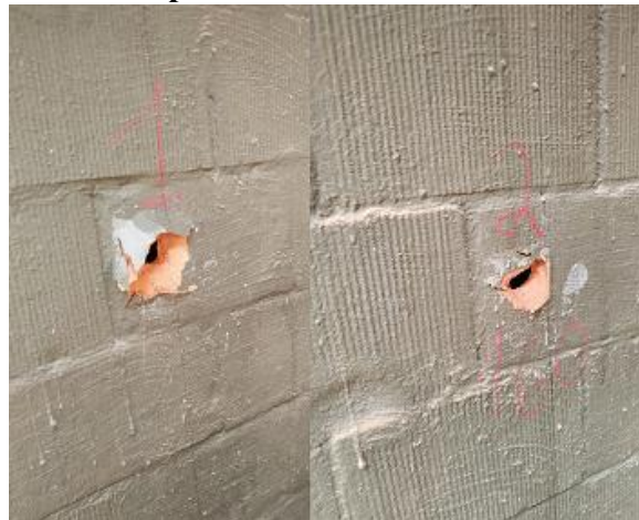
Figura 68 – Ruptura ocorrida nos blocos de 18MPa
