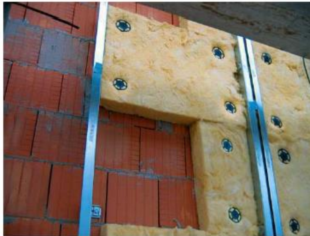
Figura 15 – Isolamento térmico em lã de rocha aplicado em fachada ventilada
