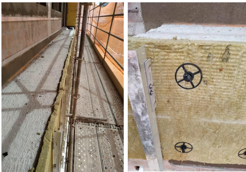
Figura 88 – Detalhes do isolante térmico de lã de rocha
