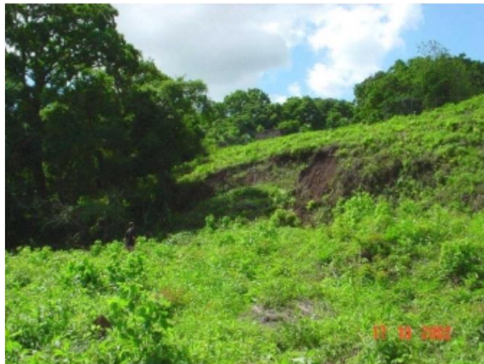
Figura 8 - Ruptura Rotacional no Bairro Santo Inácio - SCS
