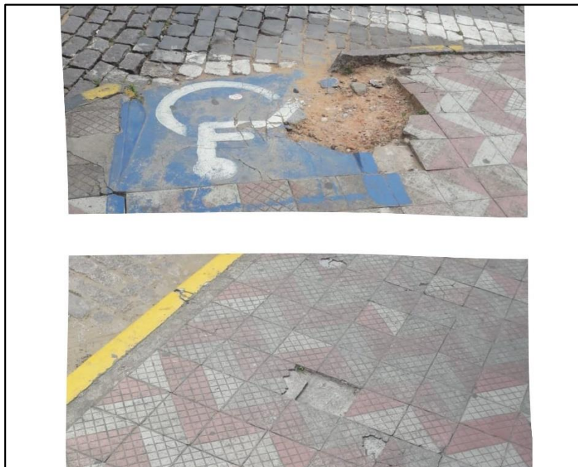
Figura 12 – Presença de buracos devido a remoção de peças soltas de ladrilho hidráulico
