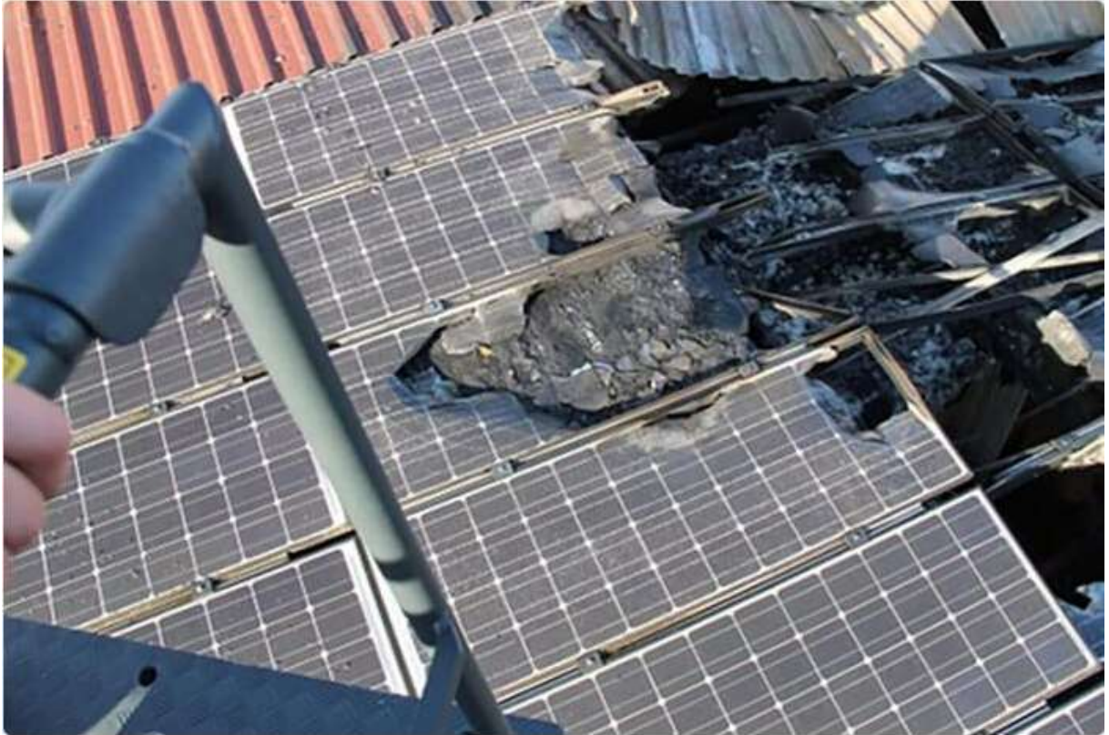
Figura 25 - Dano causado por efeito de sombreamento
