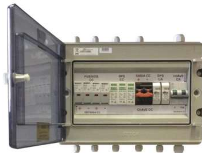
Figura 32 - Caixa com dispositivos de proteção CA e CC
