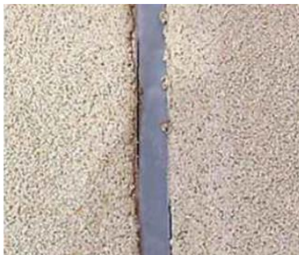
Figura 15 - Perda de adesão do selante
