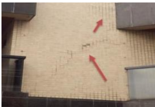
Figura 10 - Trincas em revestimento cerâmico de fachada
