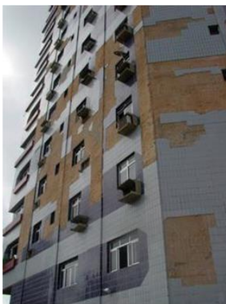
Figura 14 - Destacamento de revestimento cerâmico de fachada
