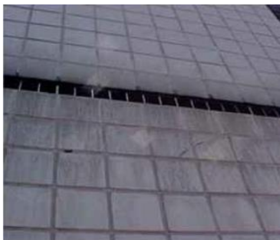
Figura 18 - Manchamento de selante
