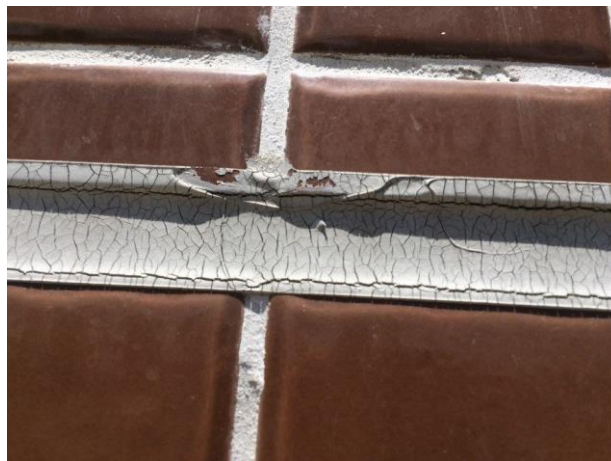
Figura 17 - Craquelamento de selante PU em juntas de movimentações de fachada
