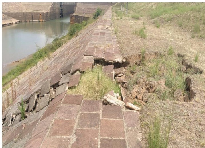
Figura 34: Detalhe danos no talude (margem esquerda)
