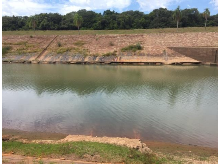
Figura 35: Detalhe danos no talude (margem direita)
