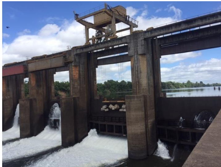
Figura 44: Comportas da barragem
