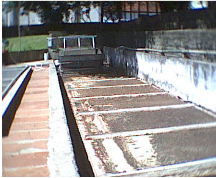
Vista do Tanque de Retenção de Graxas da ETE.
