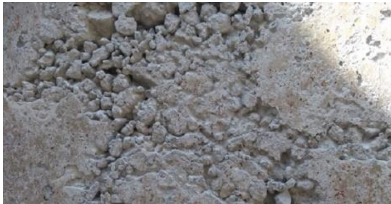
Figura 10 – Segregação do concreto
