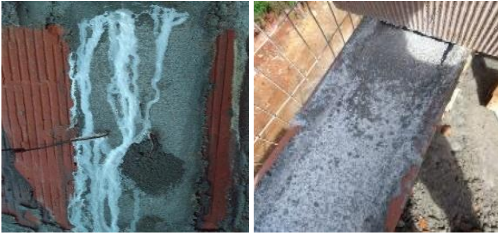
Figura 15 – Eflorescência no graute
