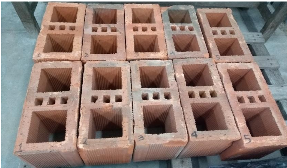
Figura 26 – Blocos cerâmicos sem aparição de eflorescência
