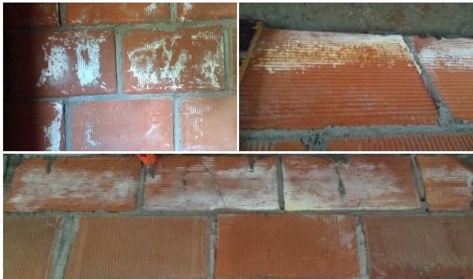
Figura 13 – Eflorescência no bloco cerâmico
