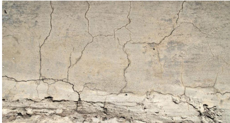
Figura 4 - Fissura por retração do concreto
