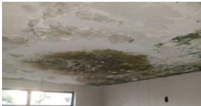
Figura 11 - Manchas de mofo no teto
