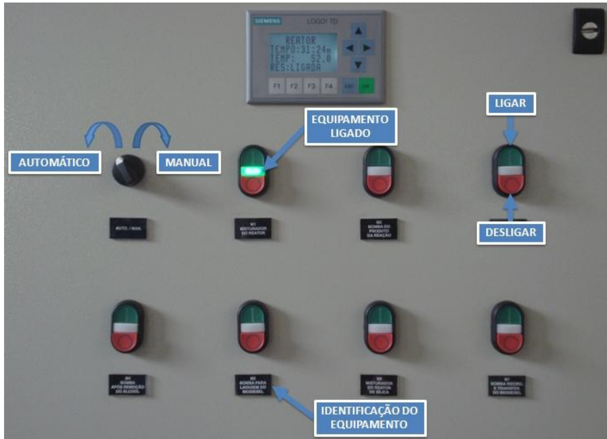
Figura 43 – Identificação da interface de operação do quadro de comando.
