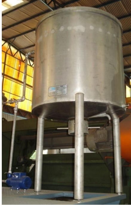
Figura 28 – Imagem do reservatório pulmão.
