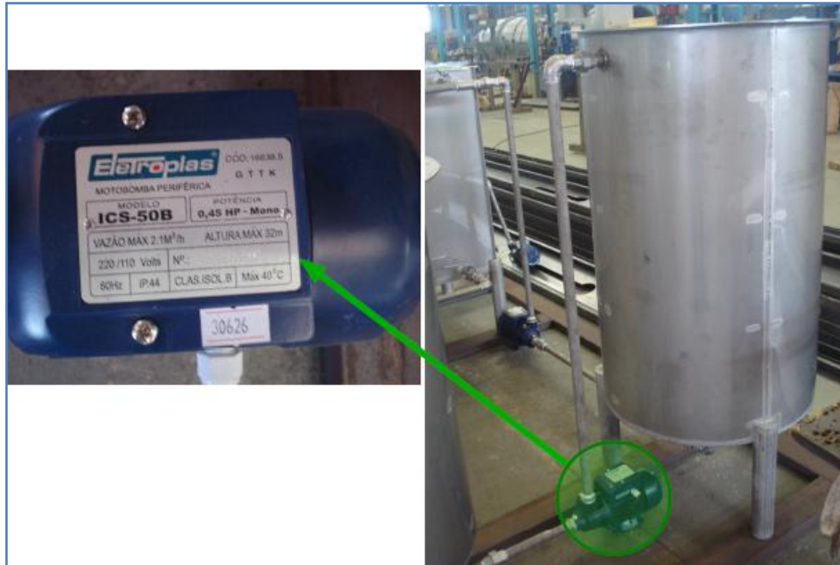
Figura 31 – Bomba centrífuga utilizada na planta.
