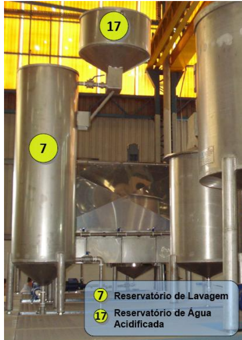
Figura 26 – Imagem do reservatório de lavagem.
