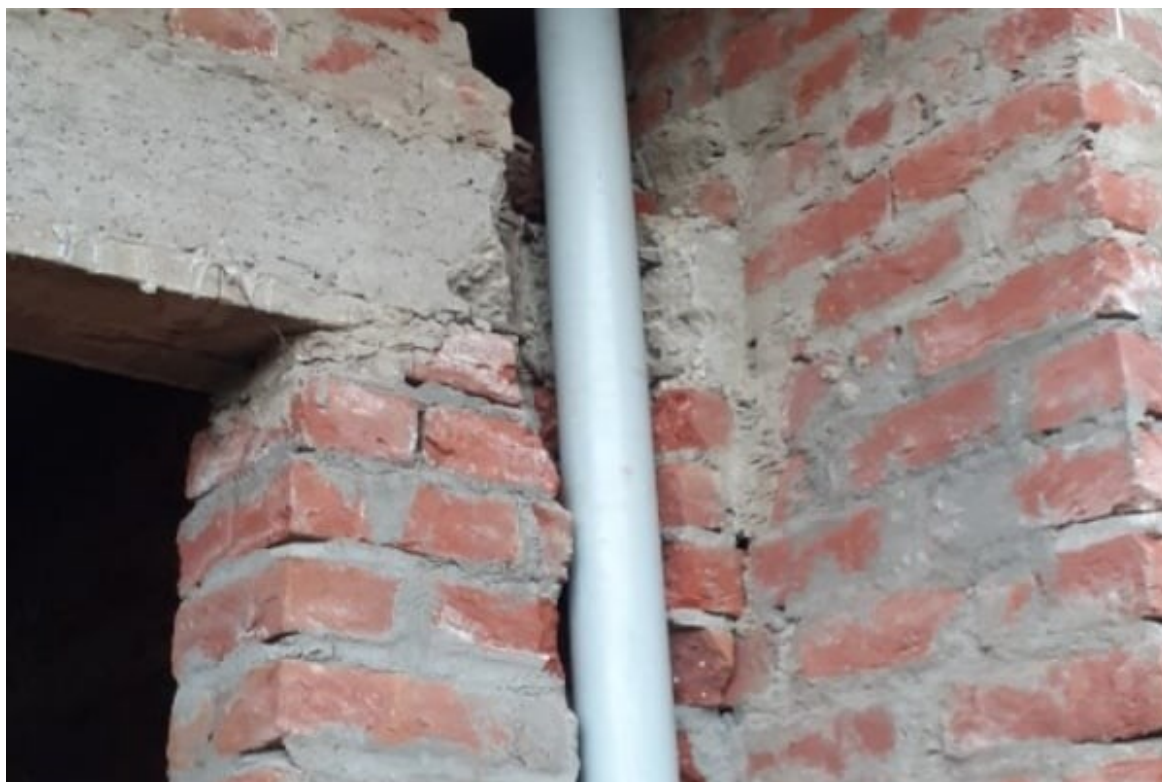
Figura 9: Resultado da falta de compatibilização de projetos.
