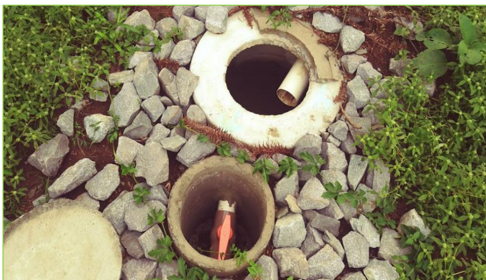
Figura 13. Detalhe do homogeneizador geral e registro para controle do fluxo.
