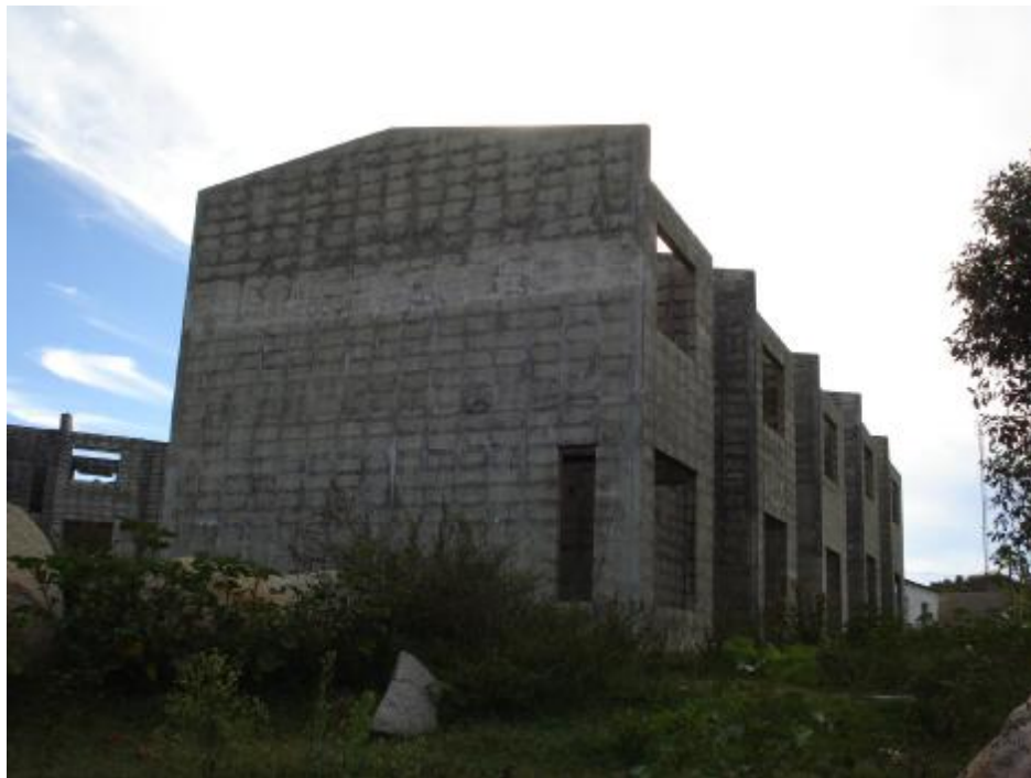
Figura 26 – Obra paralisada de um conjunto habitacional uruguaio, em Acegua, Departamento de Cerro Largo, Uruguai.
