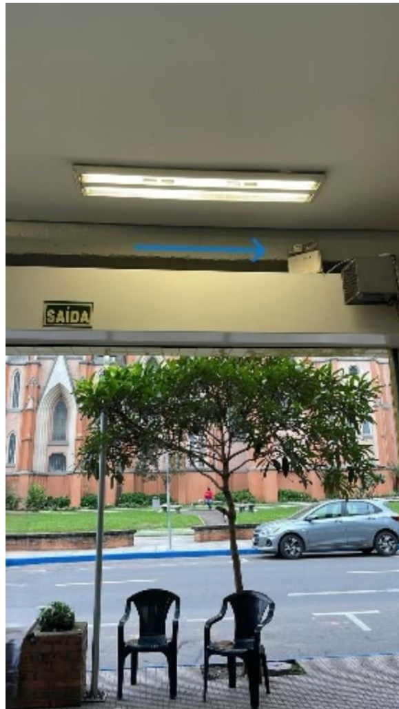
Figura 23 - Iluminação de emergência desligada
