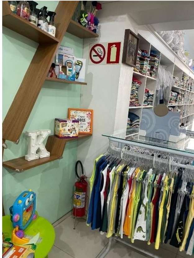
Figura 15 - Extintor de incêndio obstruído
