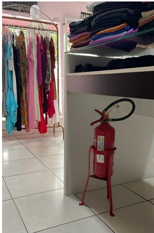
Figura 18 - Extintor de incêndio encoberto
