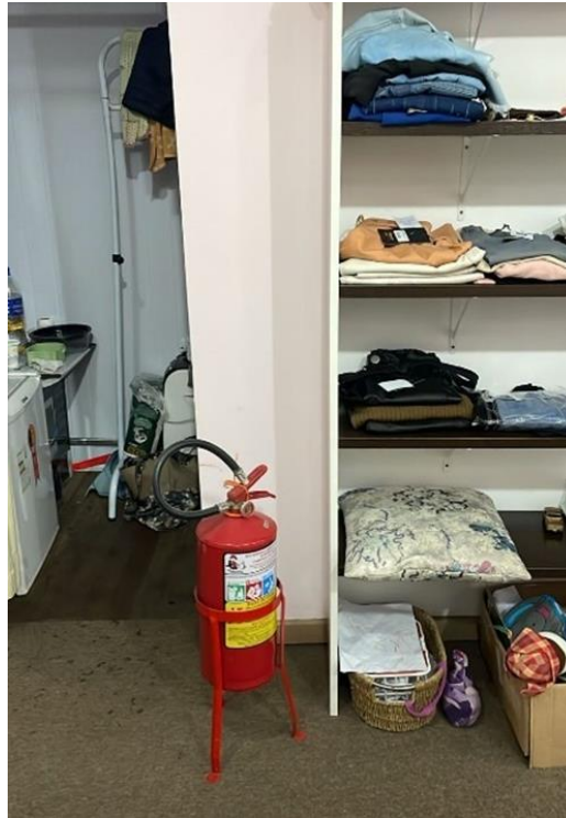
Figura 17 - Extintor de incêndio guardado
