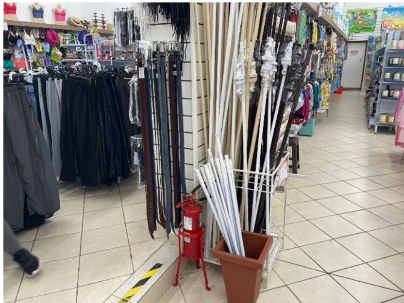
Figura 12 – Extintor de incêndio obstruído
