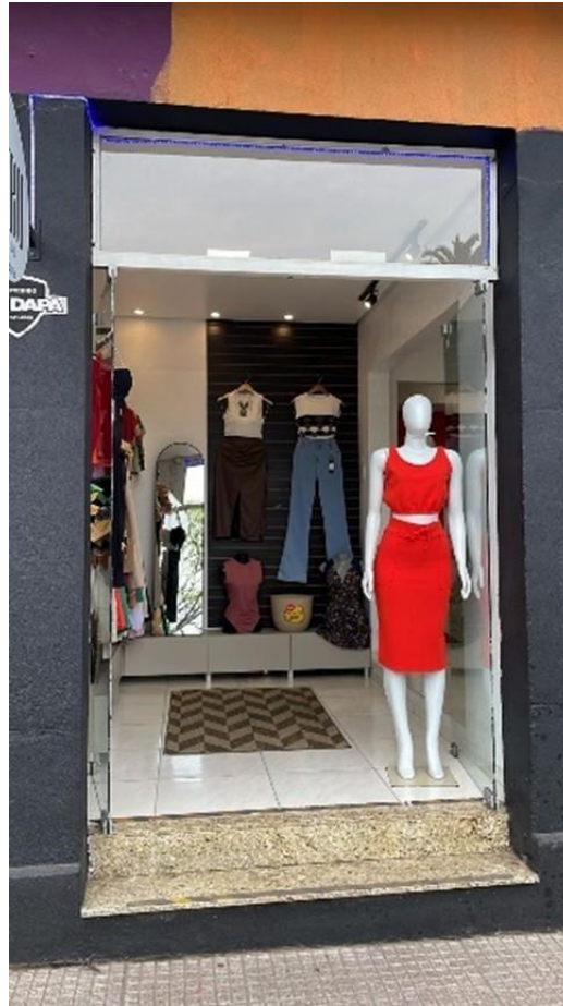
Figura 26 - Obstrução da saída de emergência
