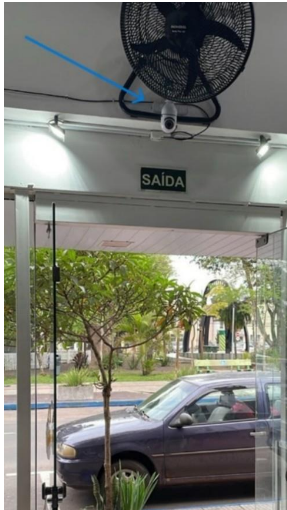
Figura 22 - Iluminação de emergência obstruída
