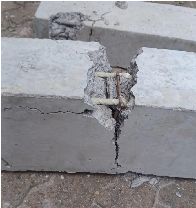
Figura 39 - Viga PRFV rompida por tração
