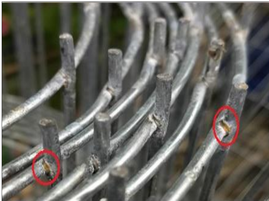
Figura 11 - Ponto de solda enferrujando no rolo
