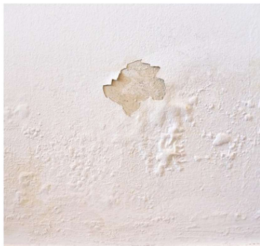
Figura 3 - Infiltração causando bolhas na pintura
