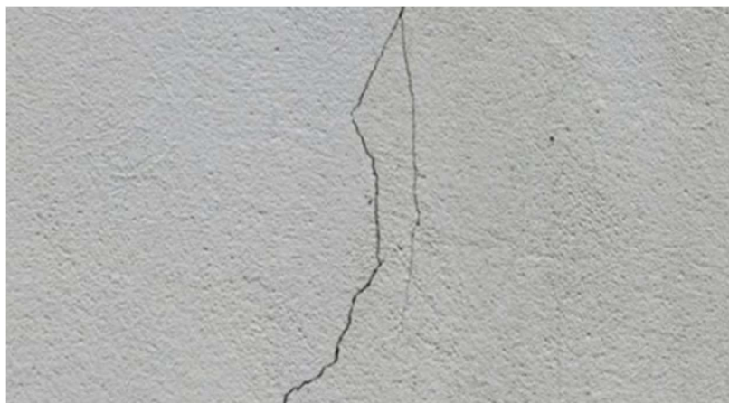
Figura 5 – Presença de fissuras na parede
