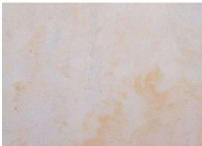
Figura 28 - Manchas amareladas em paredes e tetos
