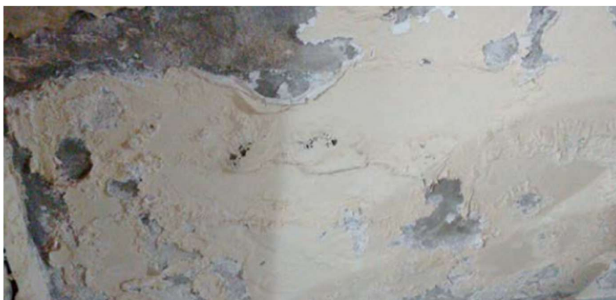
Figura 9 - Eflorescência em reboco
