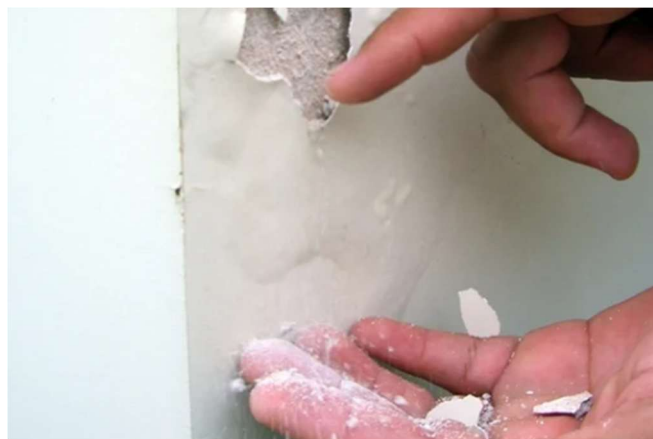
Figura 12 - Desagregamento com presença de esfarelamento em parede de alvenaria
