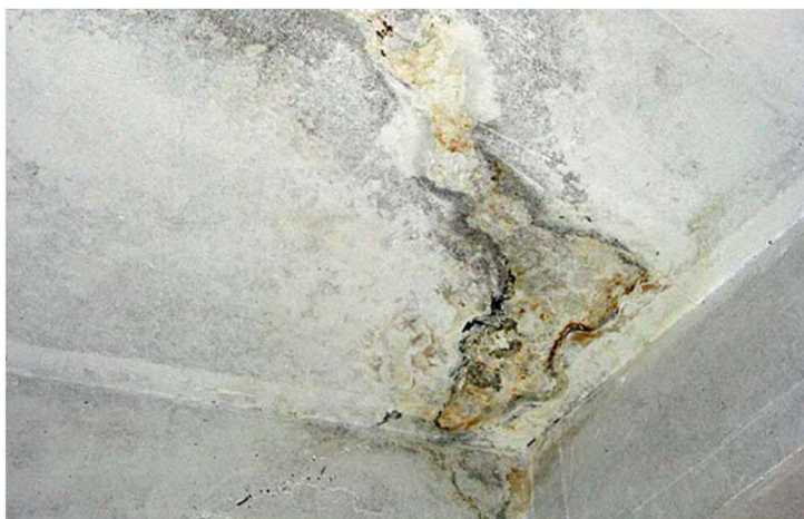
Figura 4 - Infiltração com a presença de mofo na laje
