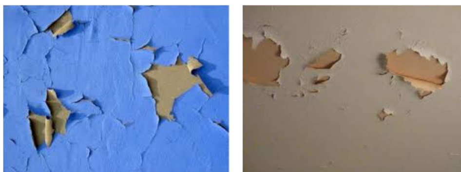
Figura 11 - Descascamento de tinta em parede de alvenaria
