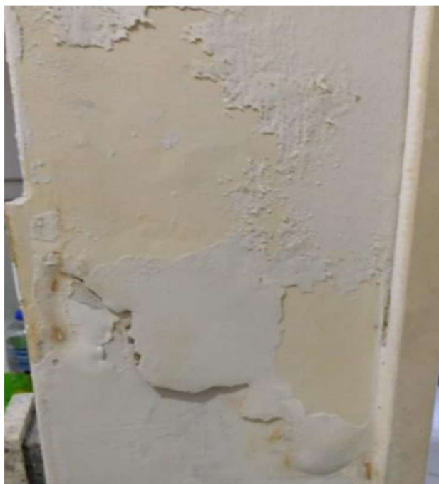
Figura 10 - Danos causados pela eflorescência no pilar
