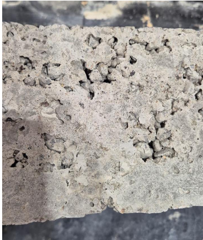
Figura 29 – Presença de orifícios na face do concreto
