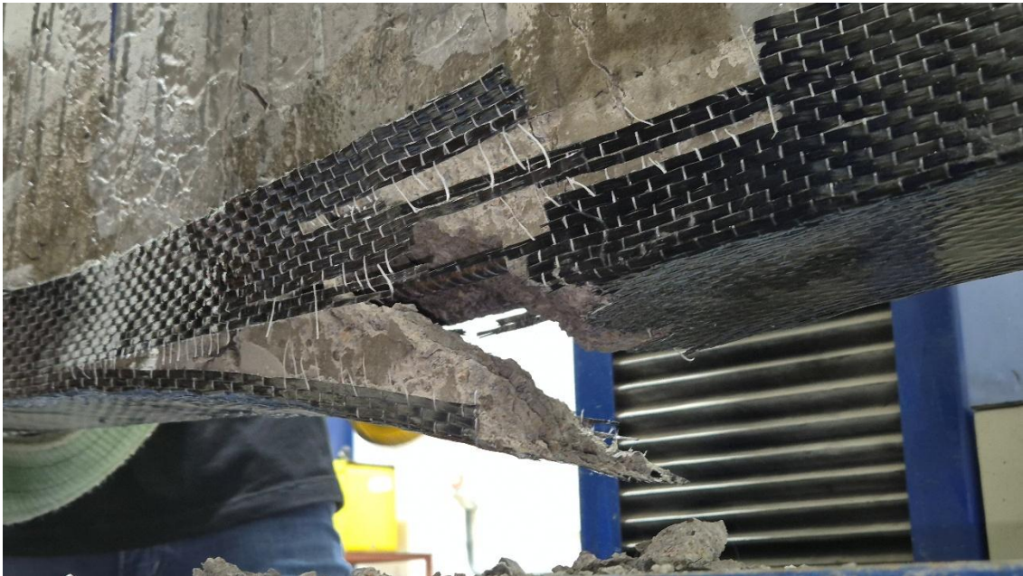
Figura 48 – Viga 2, ruptura com deslocamento do concreto
