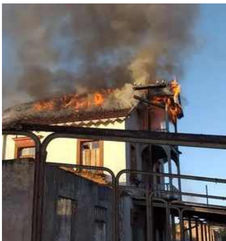
Figura 31: Incêndio em 2020 Fonte: Correio do Povo
